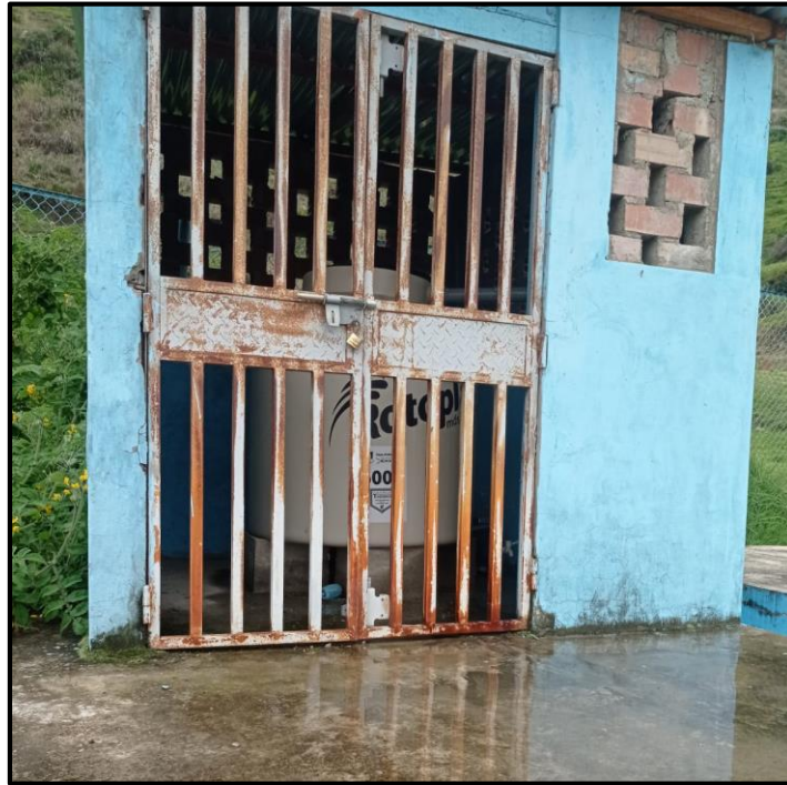
Figura 26: Caseta de Cloración del caserío de Huambo Fuente: Evidencia de Campo
