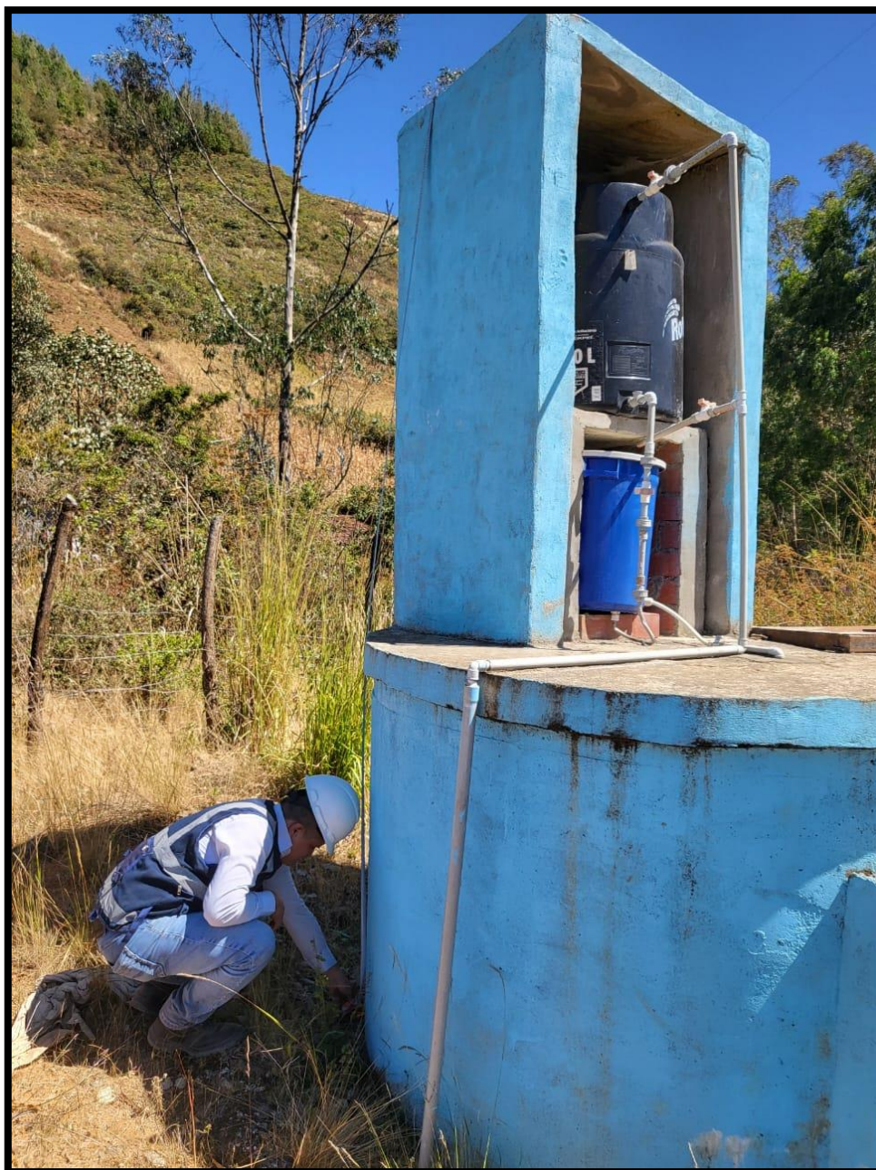
Figura 22: Alumno evaluando la estructura hidráulica- reservorio
