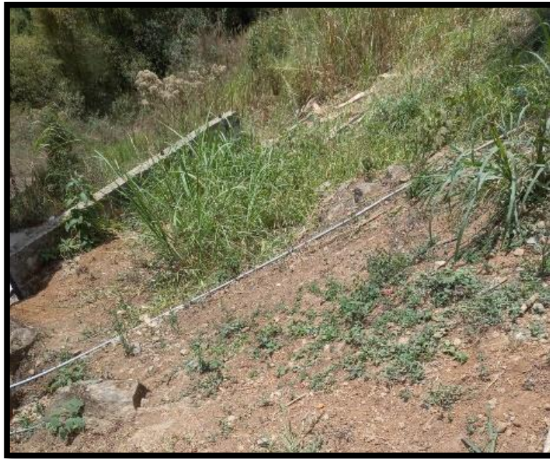
Figura 26: Red de distribución del caserío huambiche
