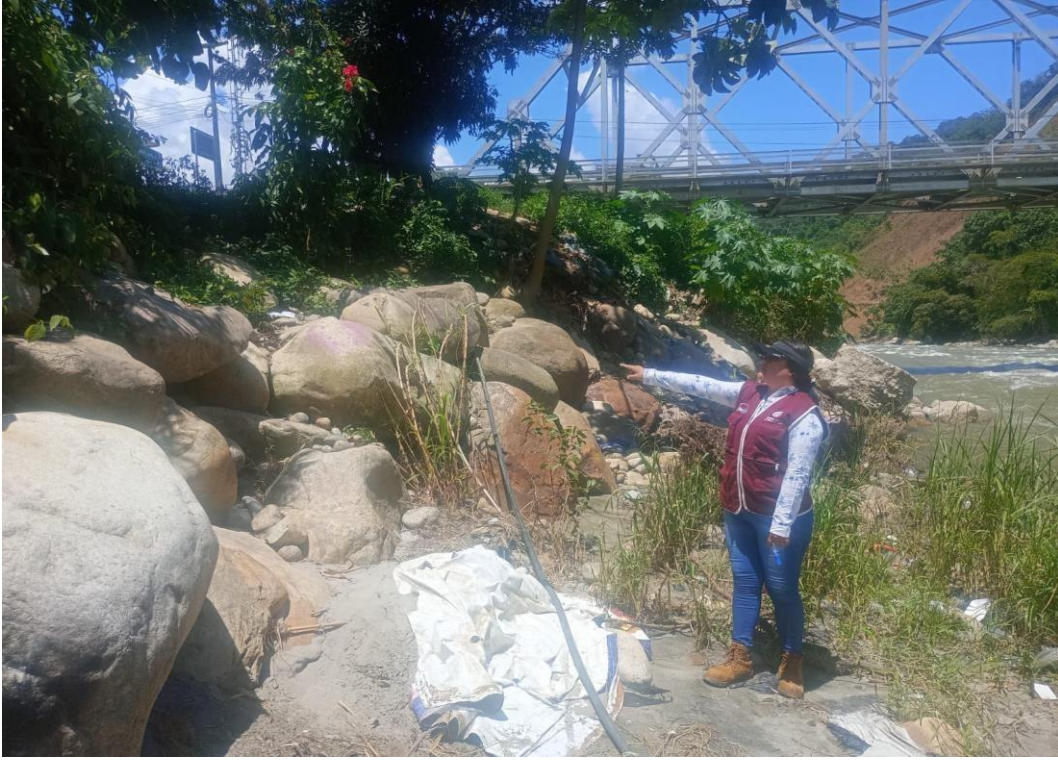
Figura 33: Presencia de socavación en el tramo 0+155
