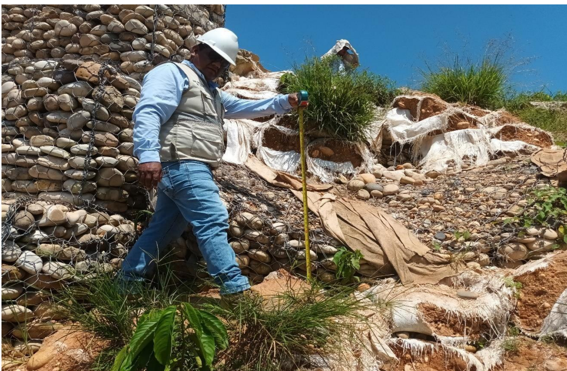
Ilustración 2: Desplazamiento de muro de gaviones
