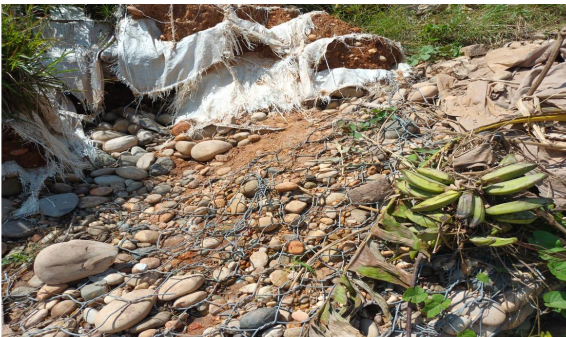
Ilustración 3: Desplazamiento de muro de gaviones
