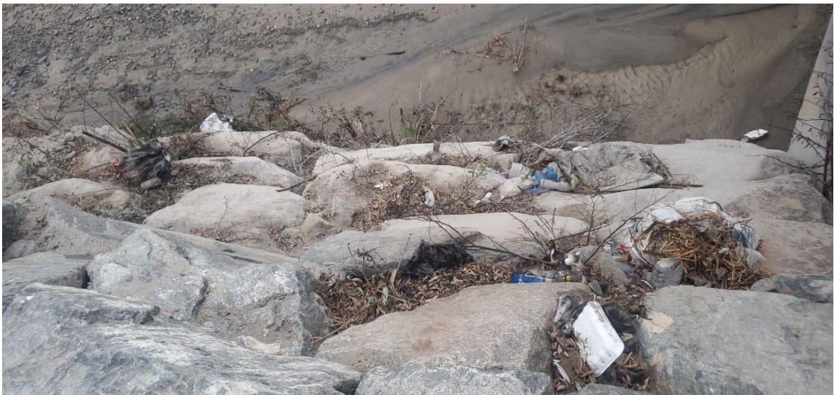
Figura 16: Se observa acumulación de basura, hierba, ramas secas que pueden perjudicar la estabilidad del enrocado
