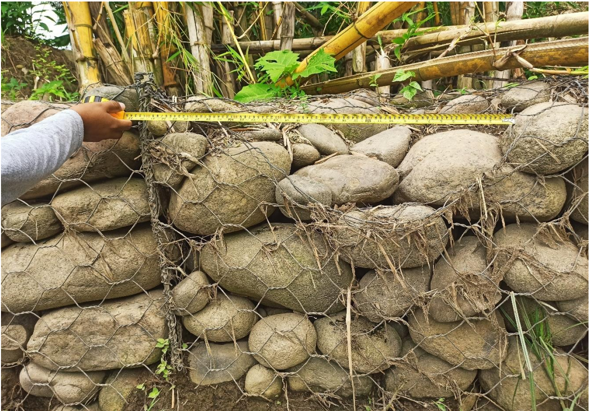
Figura 21: Malformación de la malla causado por el empuje de los gaviones
