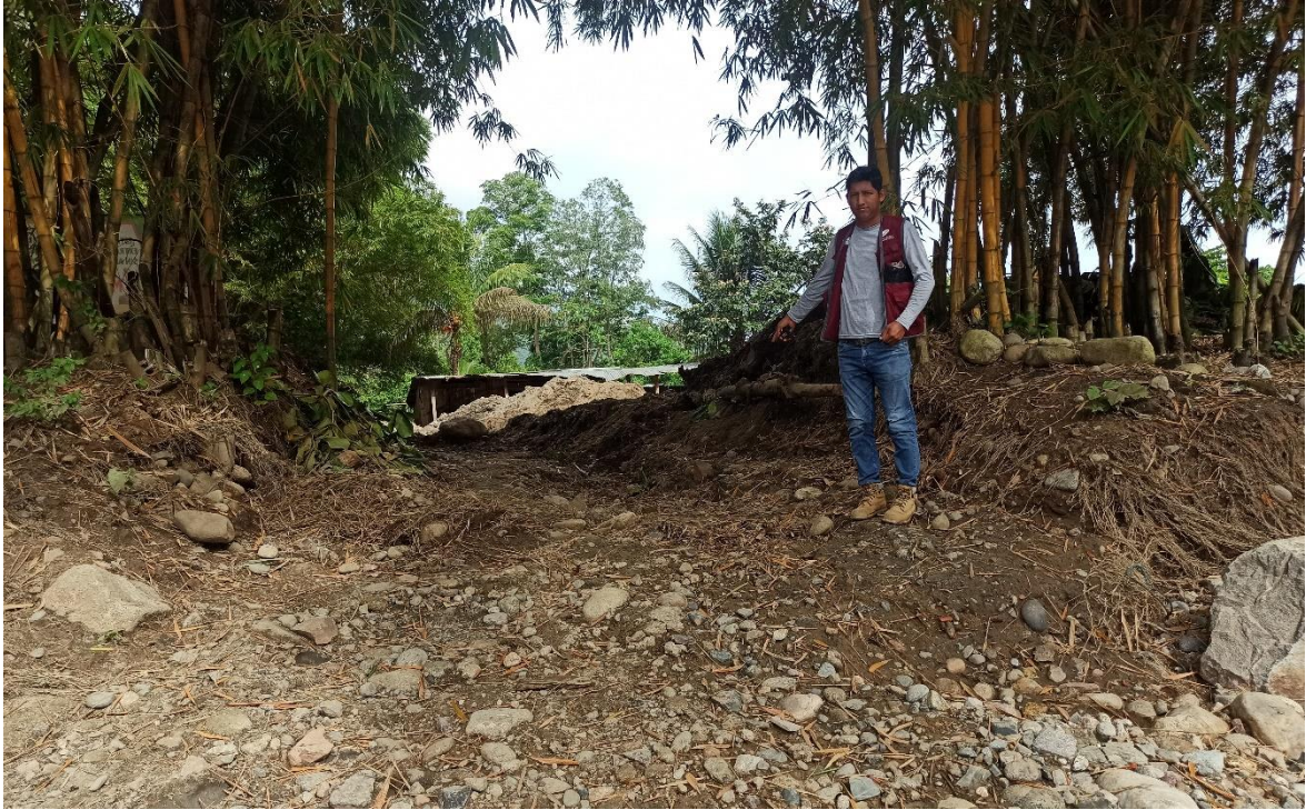
Figura 20: Muro de gavión destruida por causa del huayco (5.00 metros)
