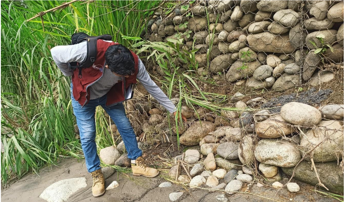
Figura 22: Malla destruida en la progresiva 0+014 ocasionando que los gaviones se salgan de la caja, perjudicando la estabilidad del muro
