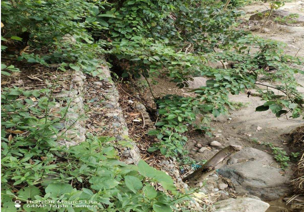
Figura 20: Presencia de vegetación en el tramo de 0+060
