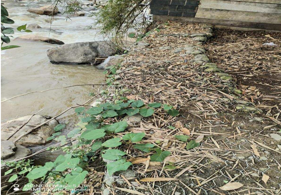
Figura 22: Presencia de escombros en el tramo 0+080
