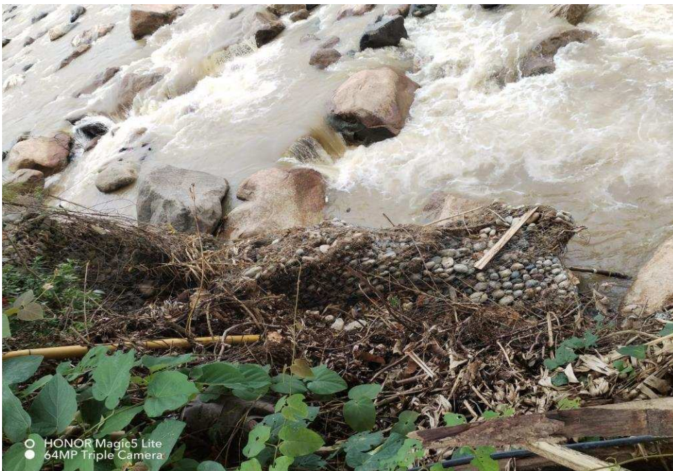
Figura 21: Presencia de acumulación de escombros en los gaviones
