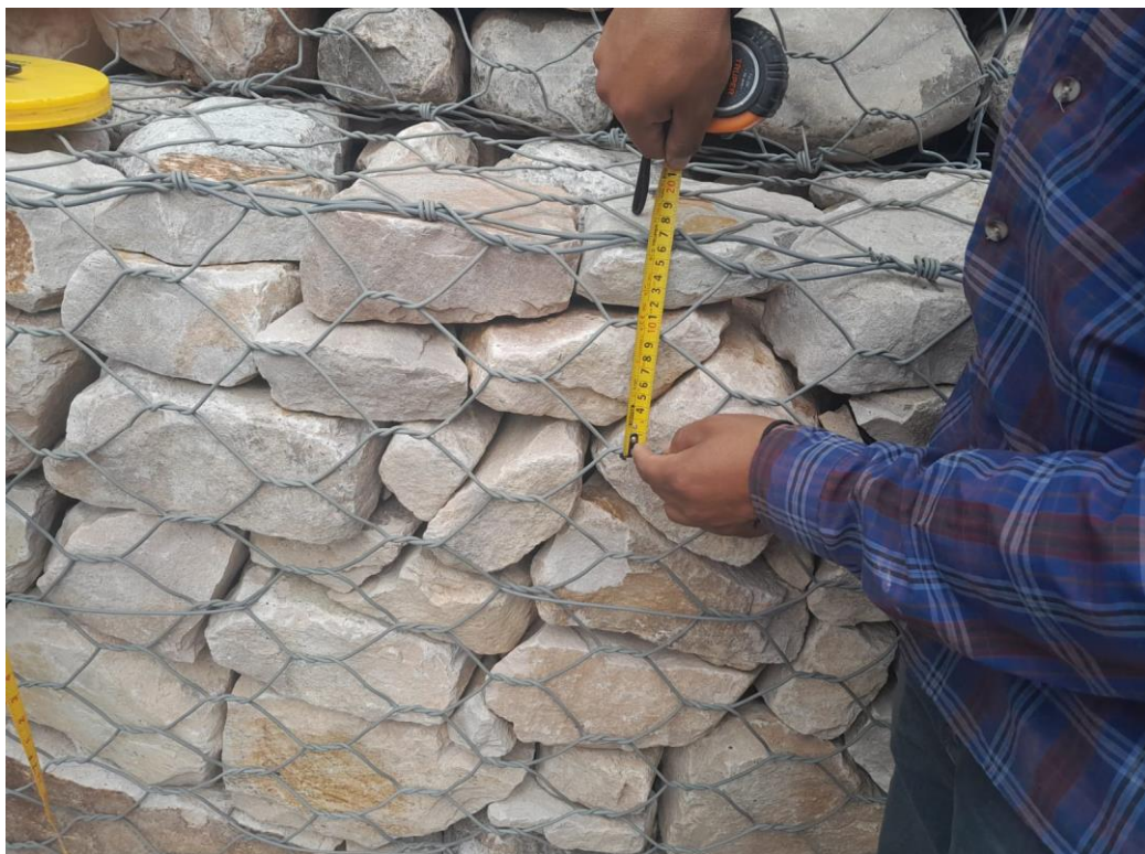
Fotografía 12: Realizando medidas de la altura de la malla
