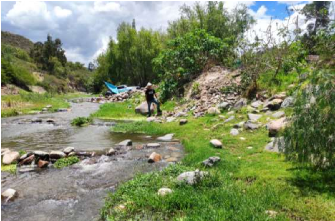
Figura 1: Inspección Visual de Gaviones deshechos margen derecho. Fuente: Elaboración Propia.
