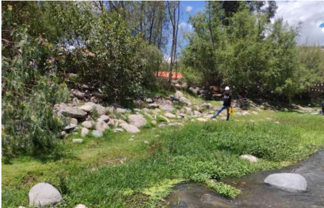
Figura 2: Inspección Visual de Gaviones deshechos margen izquierdo. Fuente: Elaboración Propia.
