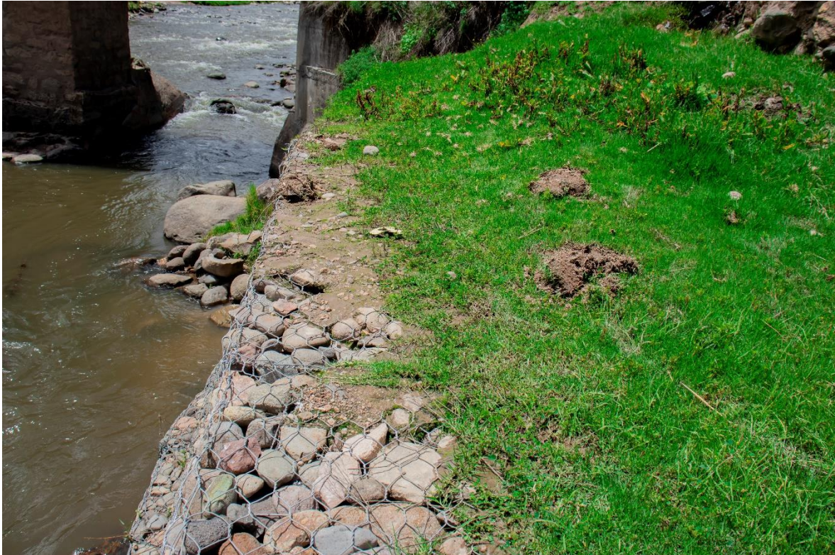
Figura 20: Se observa vegetación sobre el tercer nivel del muro de gavión
