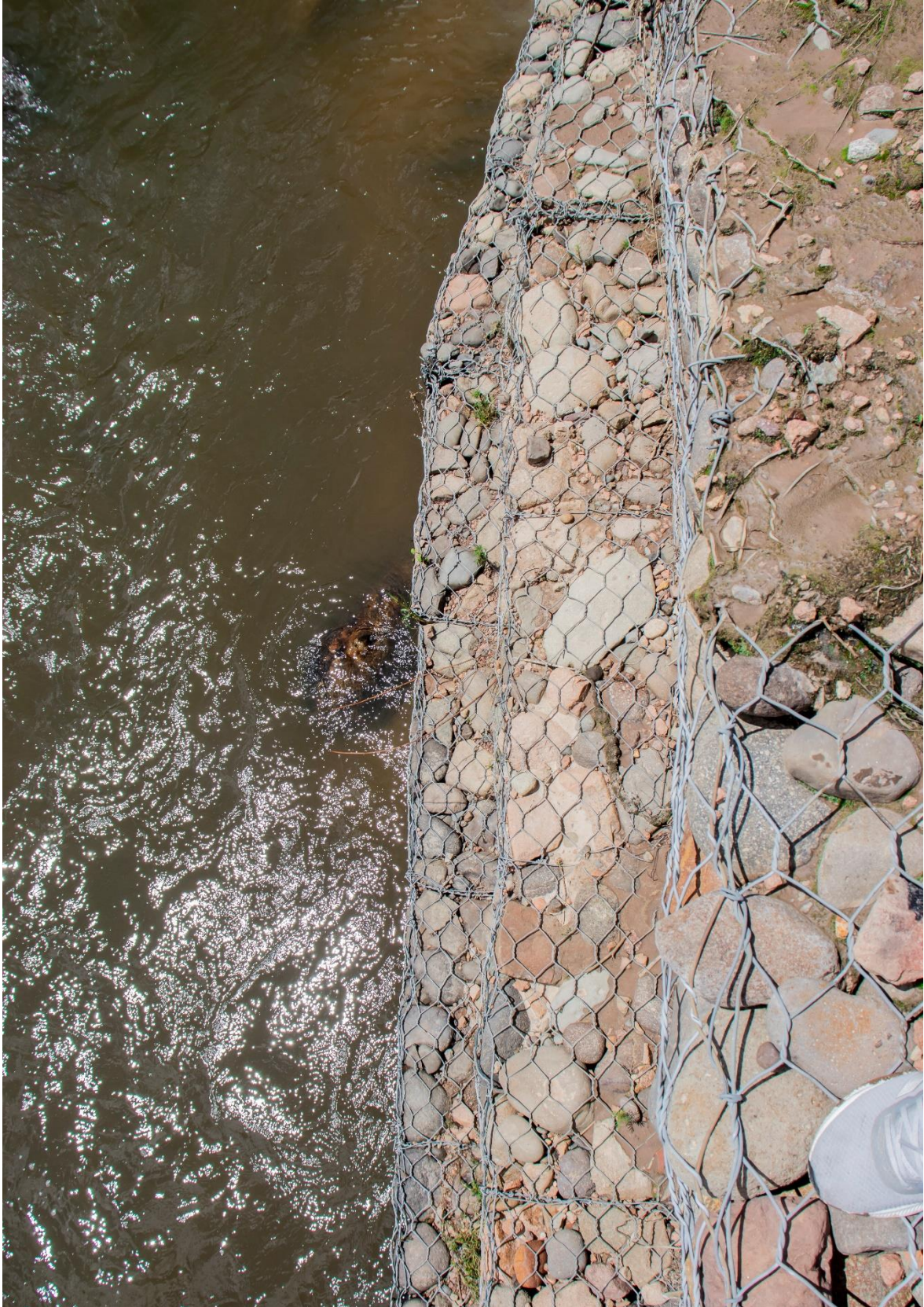
Figura 18: Se observa que la malla de alambre galvanizado se encuentra en deformacion
