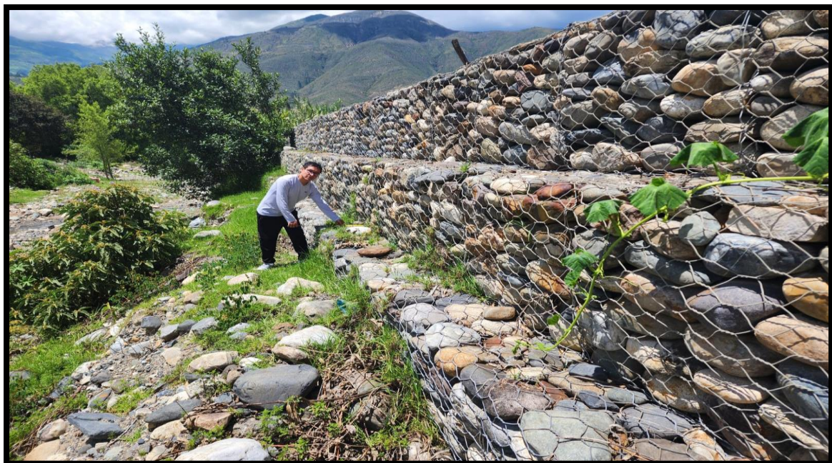
Se observa falla de la malla metálica del primer nivel de muro de gaviones en la progresiva 0+180.
