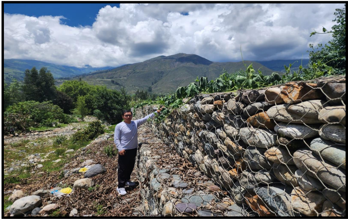
Se observa vegetación sobre el tercer nivel de muro de gaviones en la progresiva 0+150 hasta la progresiva 0+250.
