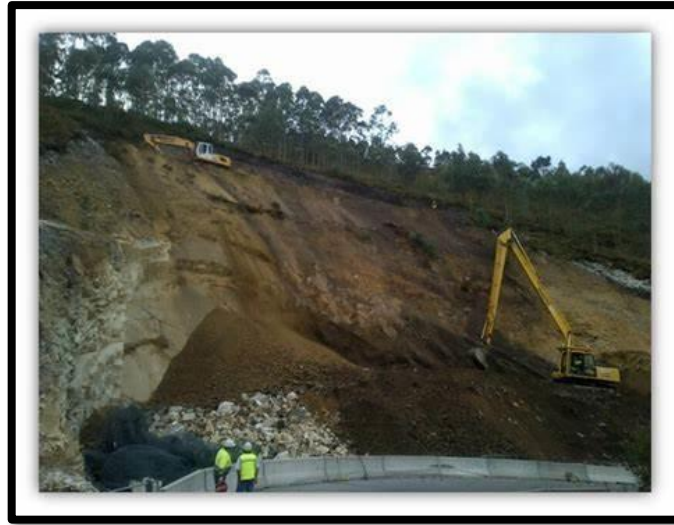
Figura 9: Deslizamiento de un talud
