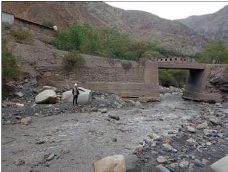
Fotografía 04: Tramo 3 en donde se observa socavación de los estribos de las zapatas del puente Sacaycacha.
