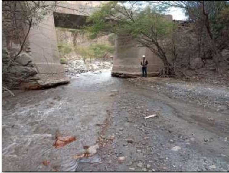
Fotografía 03: Tramo 2 en donde se observa socavación de los estribos de las zapatas del puente Sacaycacha.
