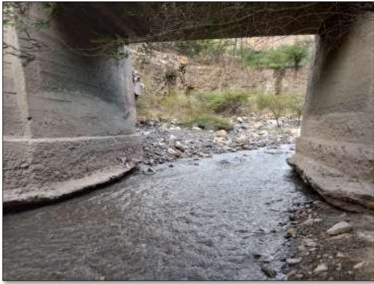
Fotografía 05: se observa más a detalle socavación de los estribos de las zapatas del puente Sacaycacha.
