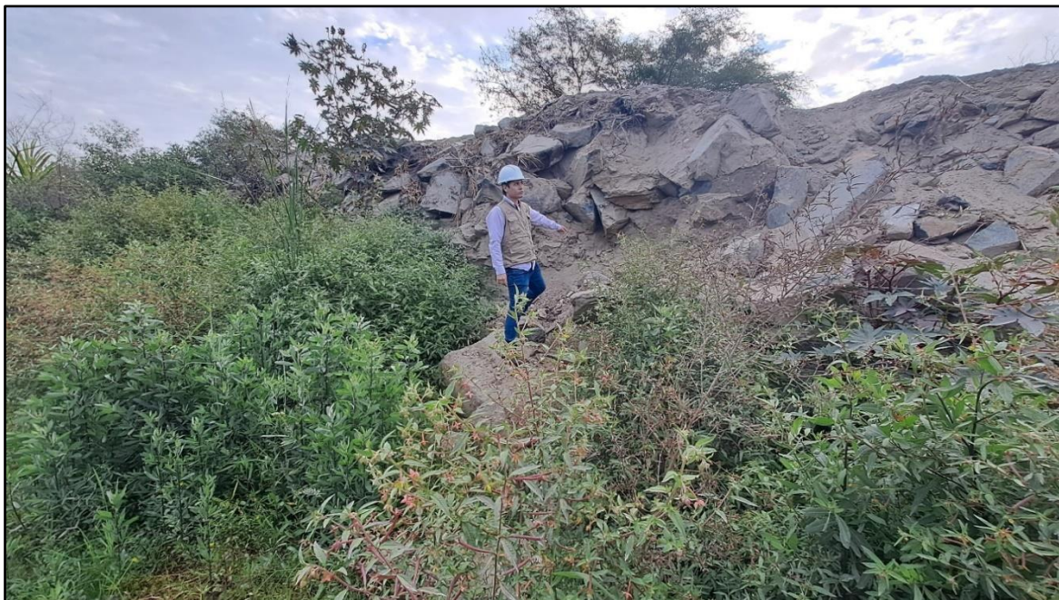
Figura 9. Caída de parte de enrocado de margen derecha en el km 7+069
