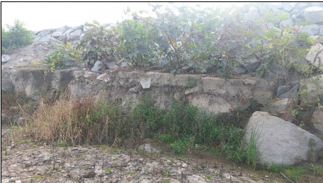
Figura 12. Observación de caída de rocas de la ña del enrocado
