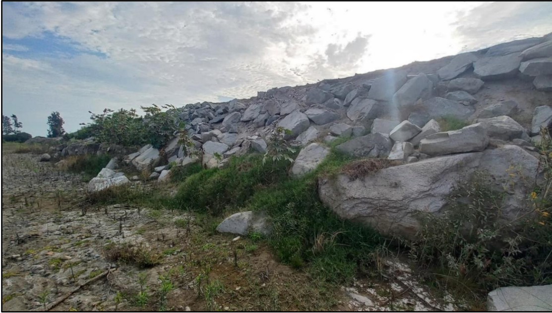
Figura 11. Observación de ña del enrocado
