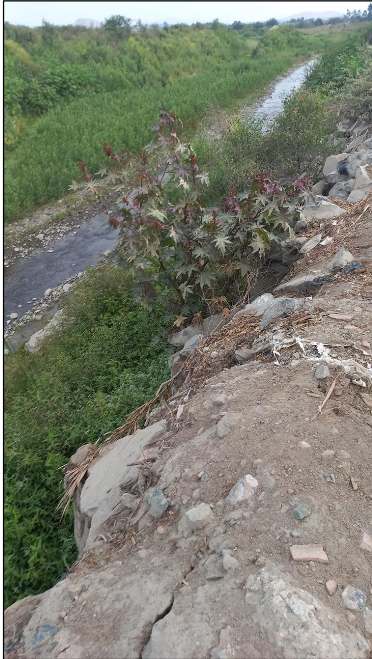
Figura 10. Falta de gran parte de enrocado de la margen derecha desde el km 7+100 a 7+150
