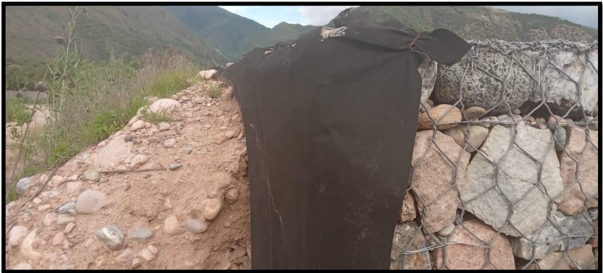
Figura 16: El geotextil está expuesto a la intemperie.
