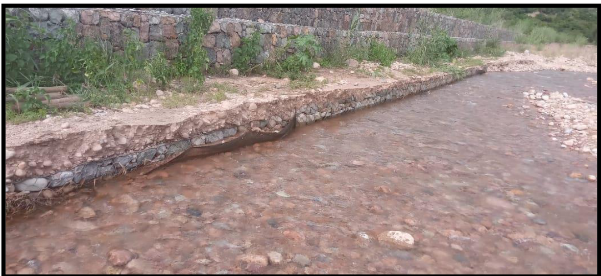
Figura 17: Se ve que el agua está socavando el colchón reno y a su vez ha desprendido el geotextil.
