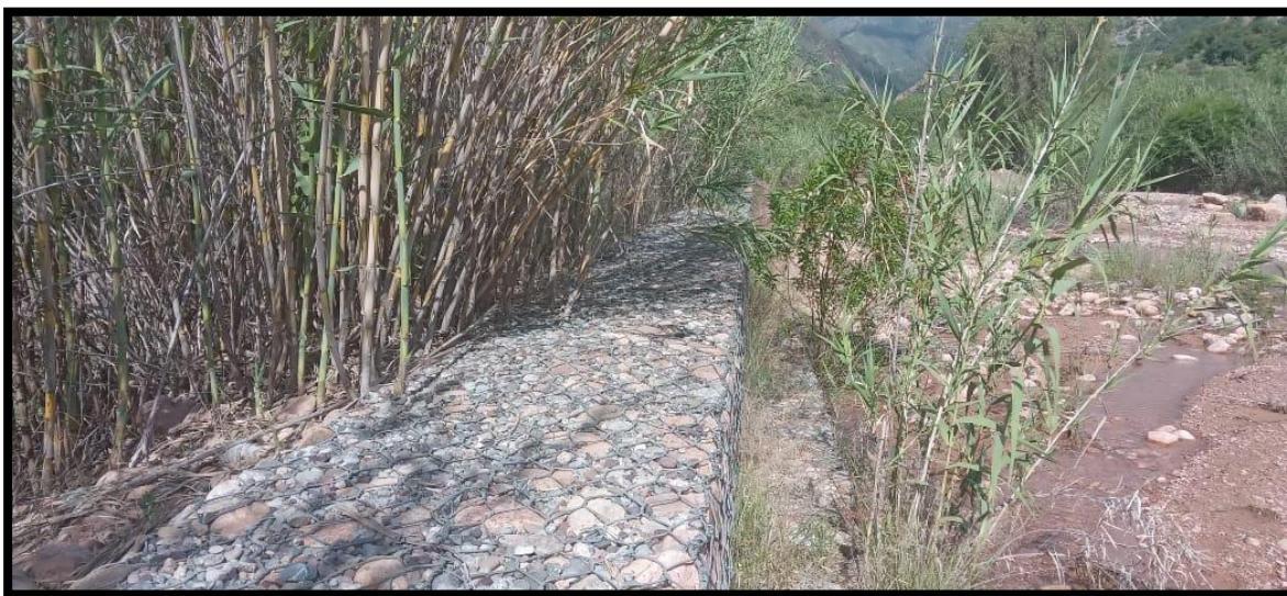
Figura 12: La vegetación está creciendo en el muro de gavión. Fuente: Elaboración propia.
