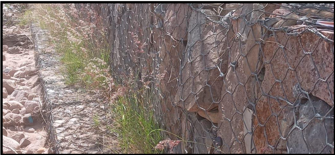
Figura 10: Se visualiza vegetación creciendo en el gavión y una roca que se salió de su posición original.
