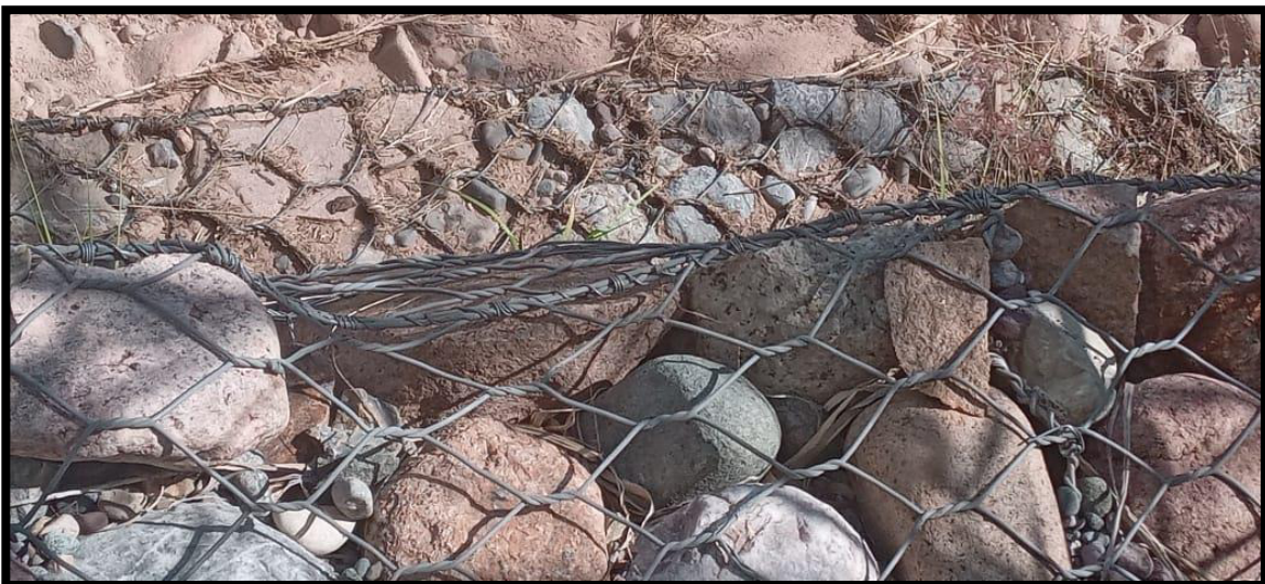
Figura 11: El gavión del segundo nivel se asentó debido a que se salieron las piedras pequeñas.
