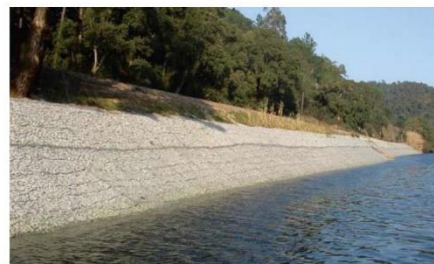
Figura 2. Gaviones para contención fluvial. Fuente:(A Bianchini, 2017).
