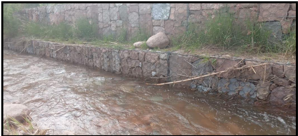
Figura 9: Como se visualiza el agua est1 llegando al primer nivel del muro de gavi3n de tipo caja. Fuente: Elaboraci3n propia.
