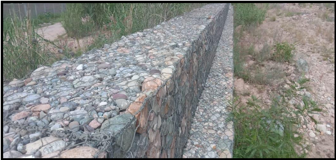
Figura 14: El colchón Reno se encuentra enterrado por la sedimentación del río.
