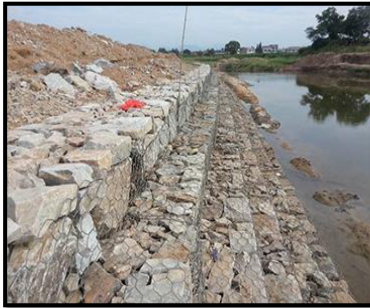
Figura 6: Desgaste del enrocado
