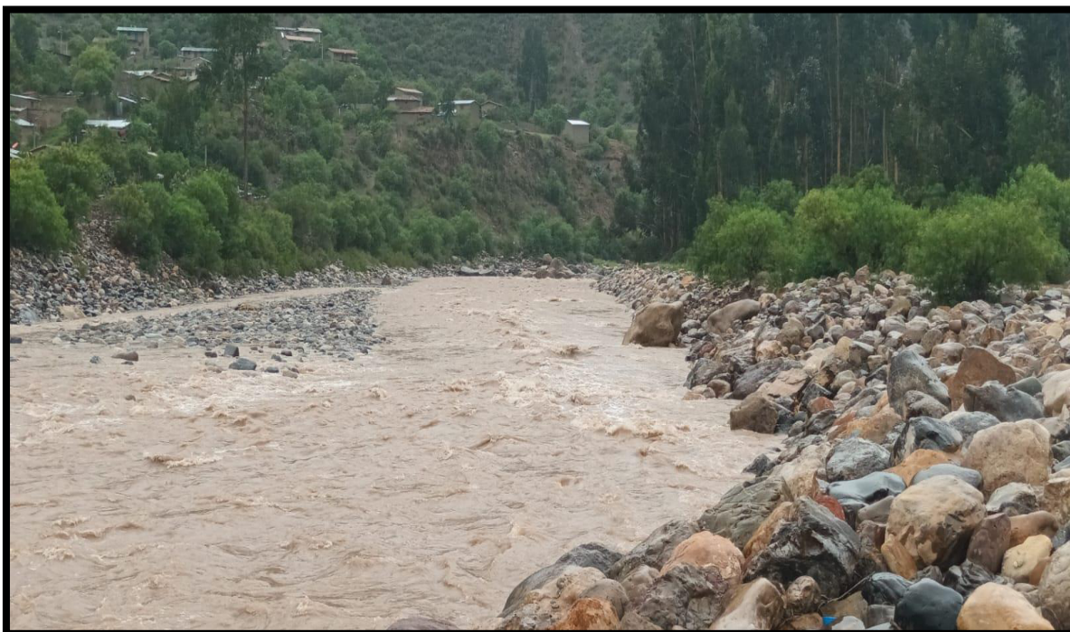
Figura 21: Vista panorámica de la defensa ribereña, enrocado derrumbado en diferentes progresivas
