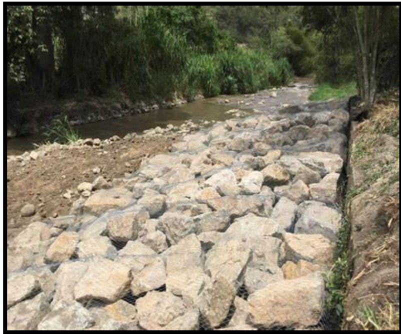
Figura 5: Desgaste del enrocado
