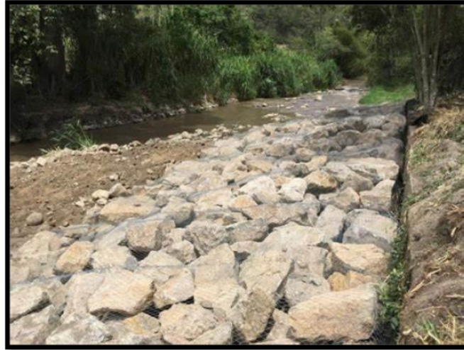
Figura 5: Desgaste del enrocado
