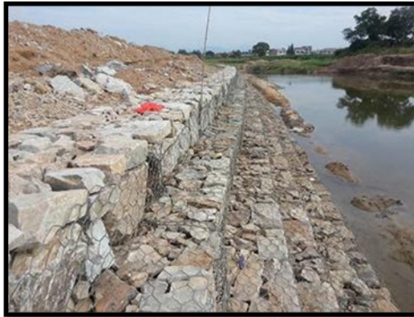
Figura 6: Desgaste del enrocado
