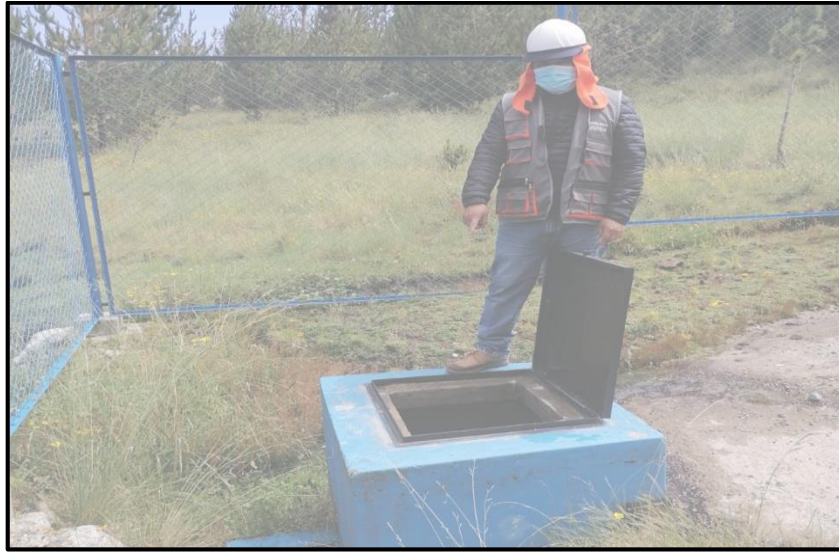
Figura 13: Tapa metálica cámara húmeda
