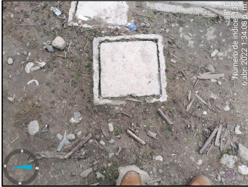
Figura 19: Caja de registro de conexiones domiciliarias
