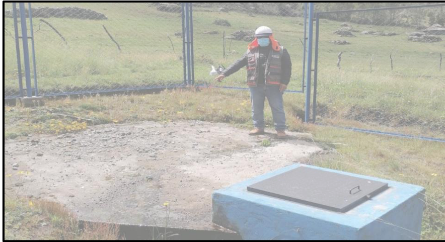
Figura 11: Cámara de captación del caserío Pumahuasi
