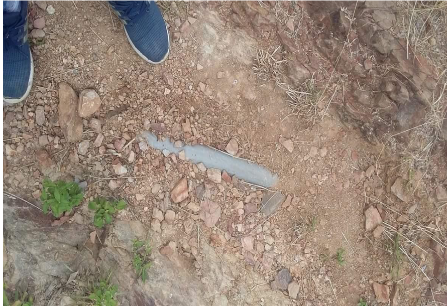
Figura 17: línea de conducción Fuentes: elaboración propia (2021)
