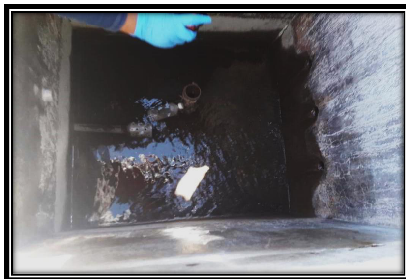
Figura 16: cámara de captación Fuente: elaboración propia (2017)
