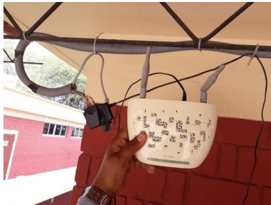
Figura 14 Access Point TP-Link y conexiones de
