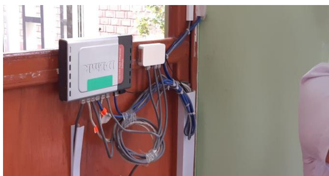
Figura 16 Swiches Dlink y cableado actual
