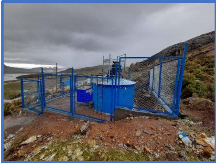
Figura 26: Cerco perimétrico para reservorio
