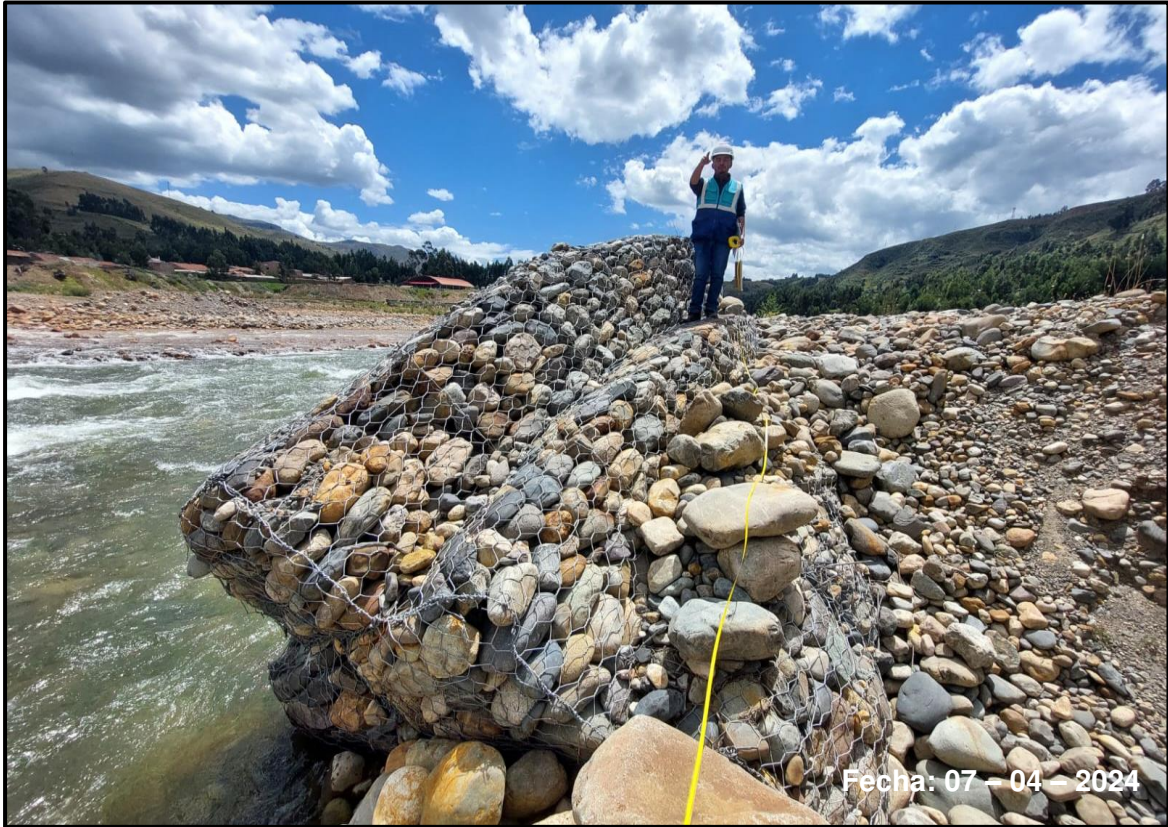
Foto 9: Se halla volteado el muro de gaviones con asentamientos en la base, producto de la socavación
