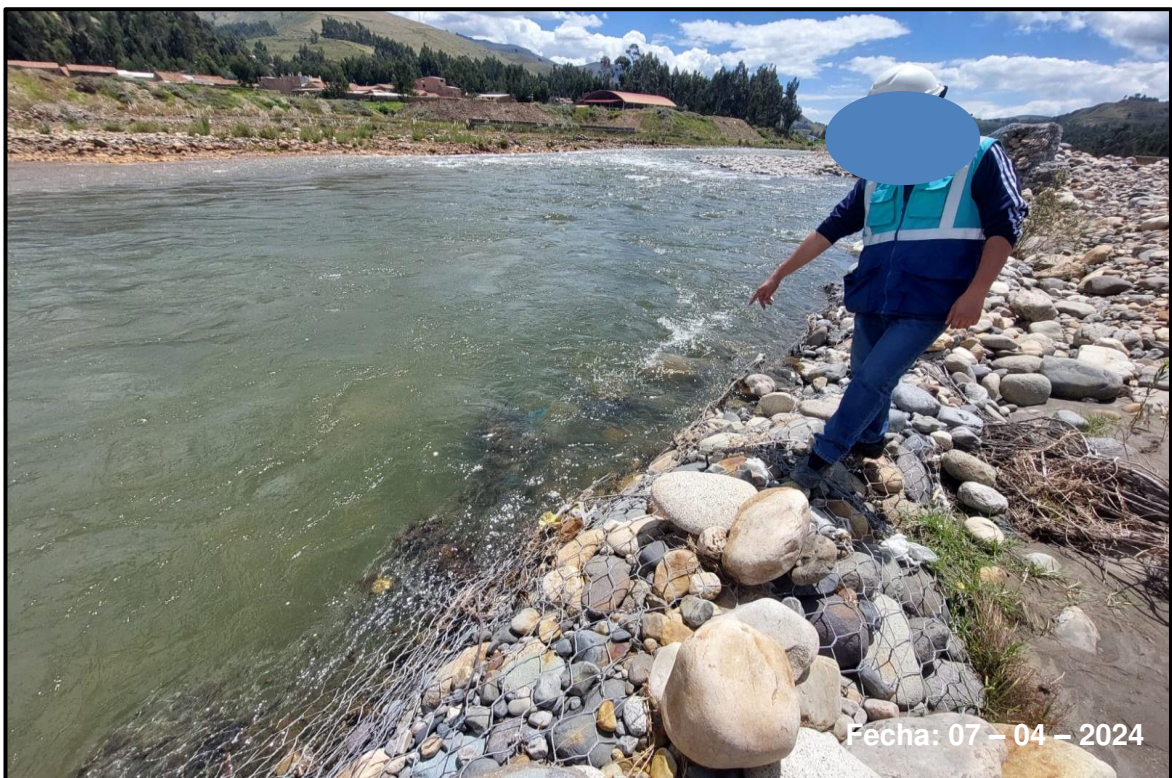
Foto 16: Se observa el colapso total del muro sumergido en las aguas del río Santa
