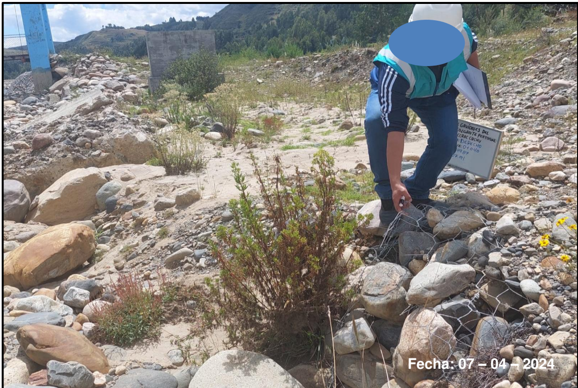
Foto 4: De la progresiva 0+040 a la 0+080, no se visualizó el muro de gaviones ya que se encuentra enterrado, notándose solo partes superficiales de la malla y el relleno
