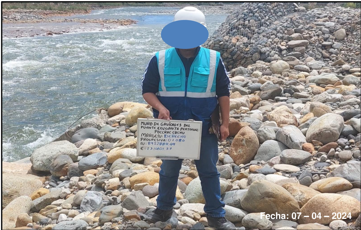
Foto 8: Se observa el punto 0+080 del muro de gaviones, vista continua al muro de gaviones
