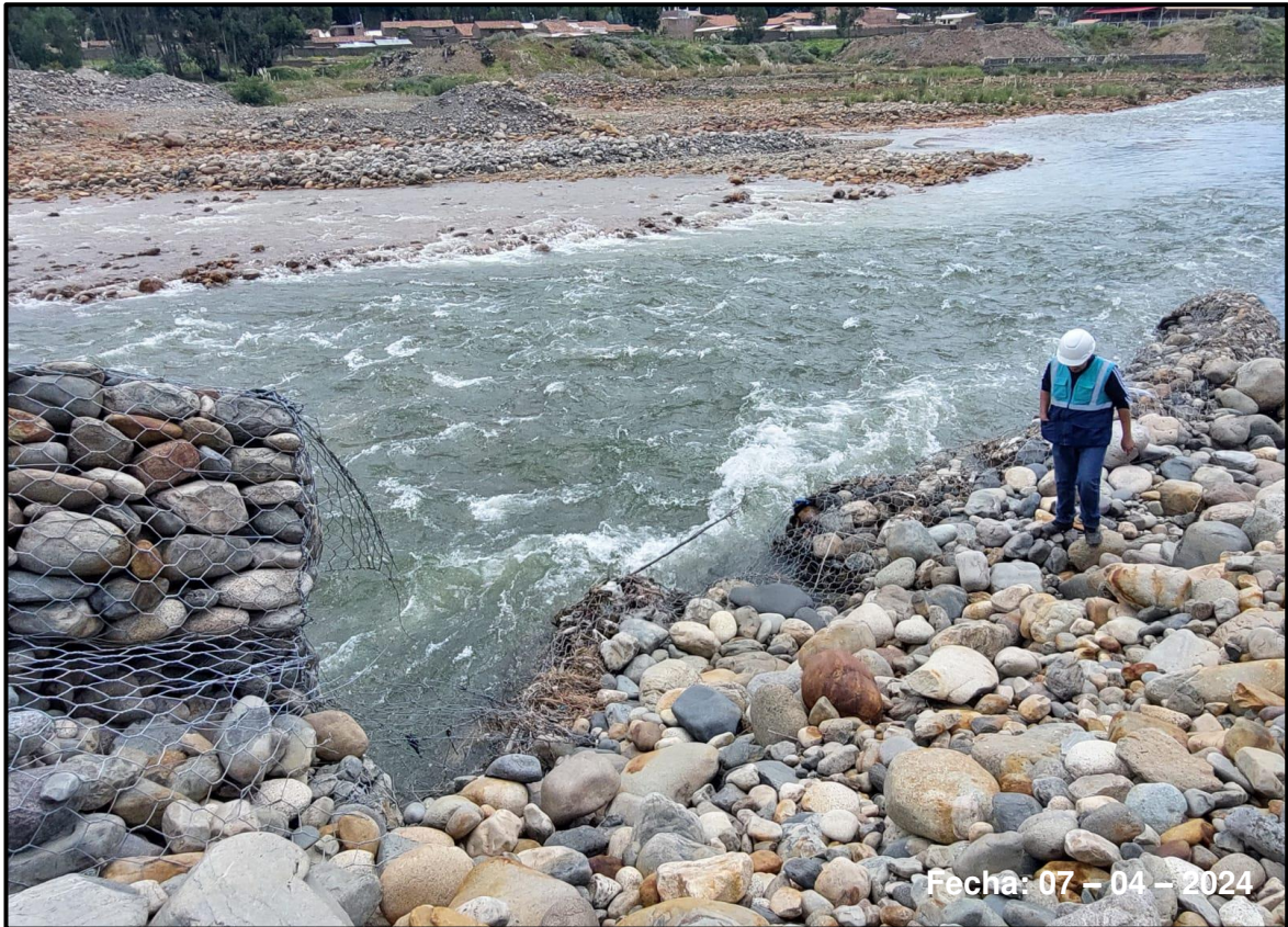
Foto 12: Se visualiza el colapso del muro, este se encuentra sumergido en el río Santa
