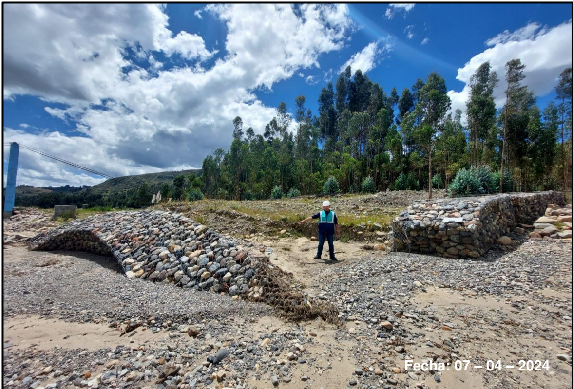
Foto 2: Se aprecian volteos de la estructura
