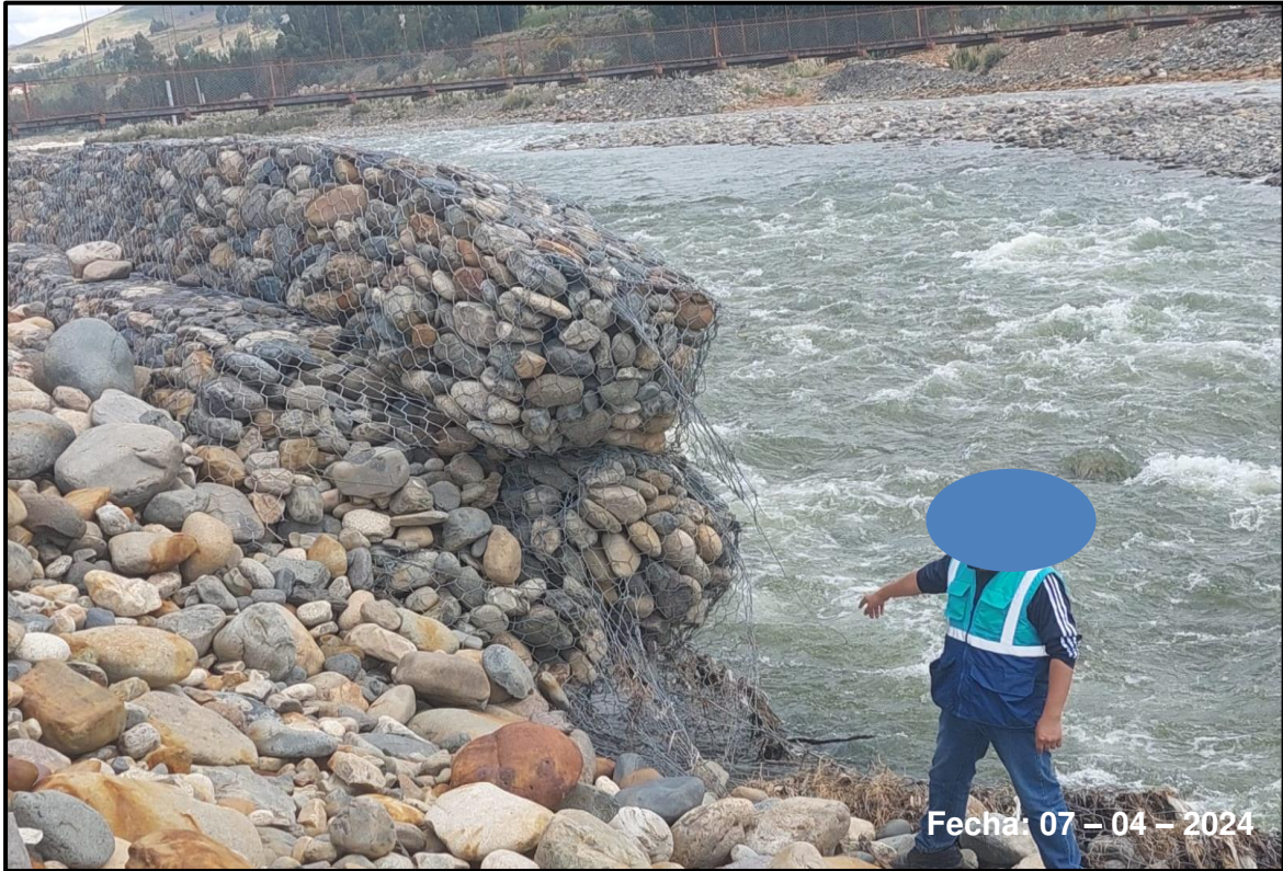
Foto 11: Se visualiza el volteo del muro con roturas en la malla
