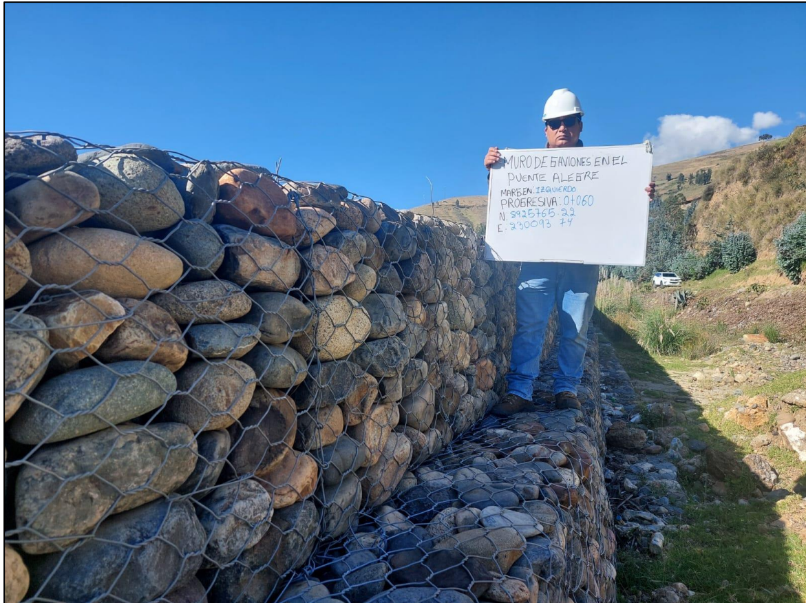
Descripción: Progresiva 0+060 del muro de gaviones del río Santa en el puente Alegre, vista 2
