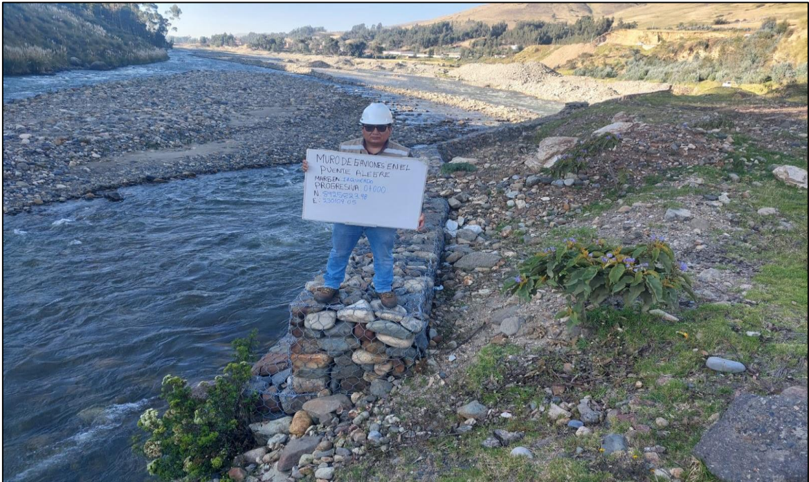
Descripción: Progresiva 0+000 del muro de gaviones del río Santa en el puente Alegre
