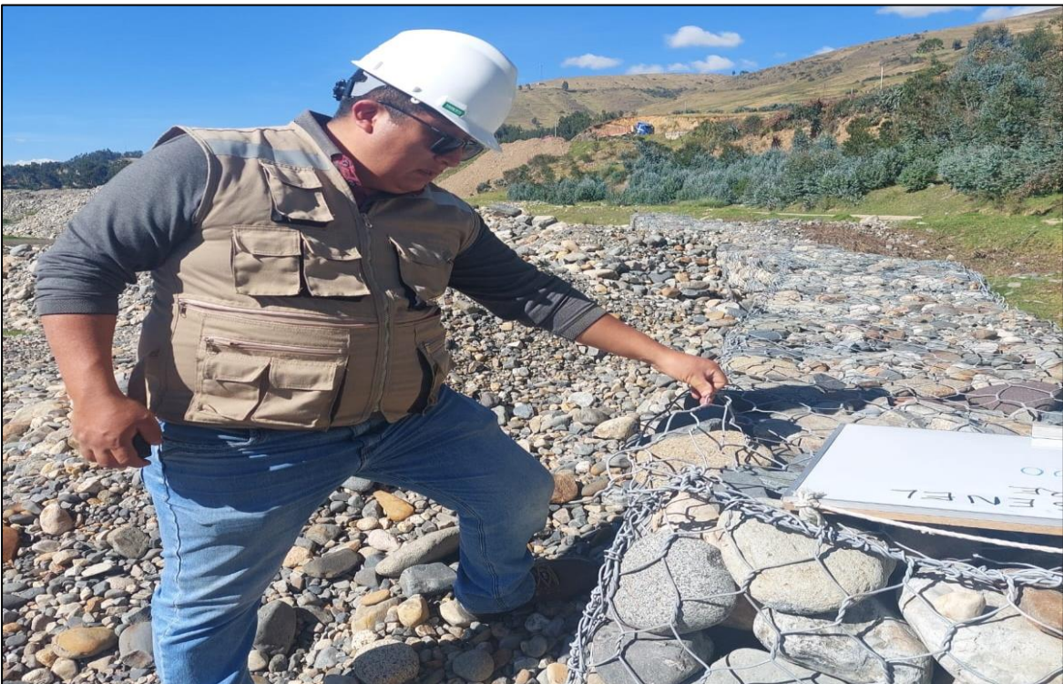
Descripción: Deformaciones en gaviones y falta de material de relleno, entre las progresivas 0+100 y 0+120.
