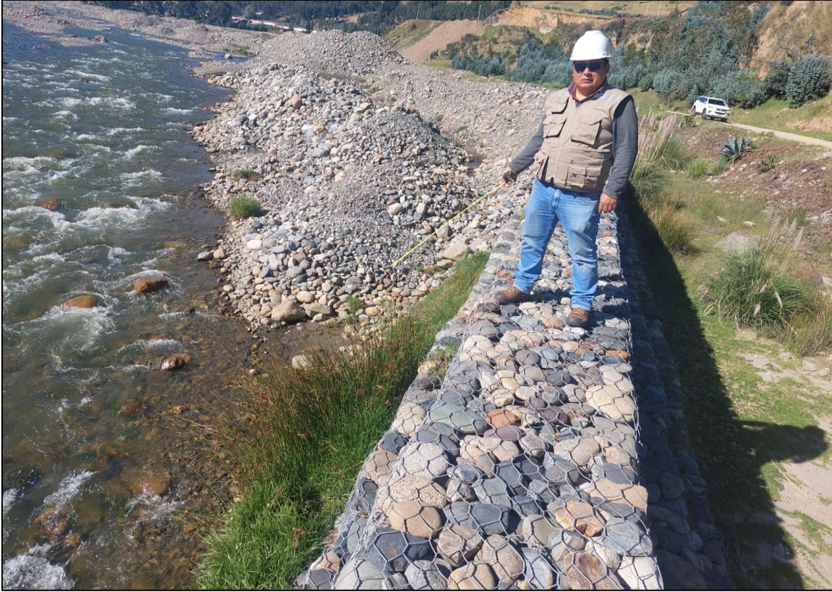
Descripción: Vegetación en el primer nivel del muro de gaviones, entre las progresivas 0+060 y 0+080.
