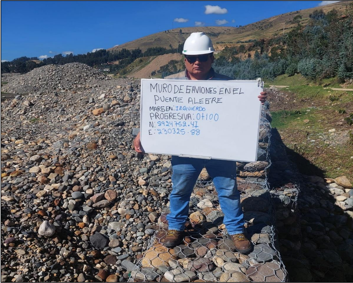
Descripción: Progresiva 0+100 del muro de gaviones del río Santa en el puente Alegre.
