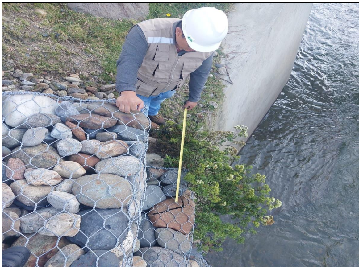
Descripción: Evidencia de roturas del material de relleno y vegetación en el tercer nivel del muro de gaviones, entre las progresivas 0+000 y 0+020.
