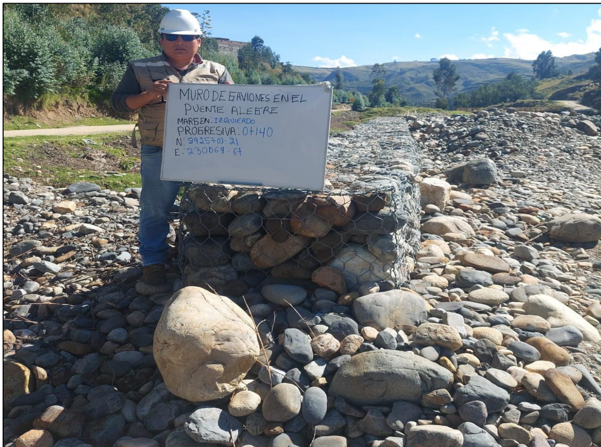
Descripción: Progresiva 0+140 del muro de gaviones del río Santa en el puente Alegre.
