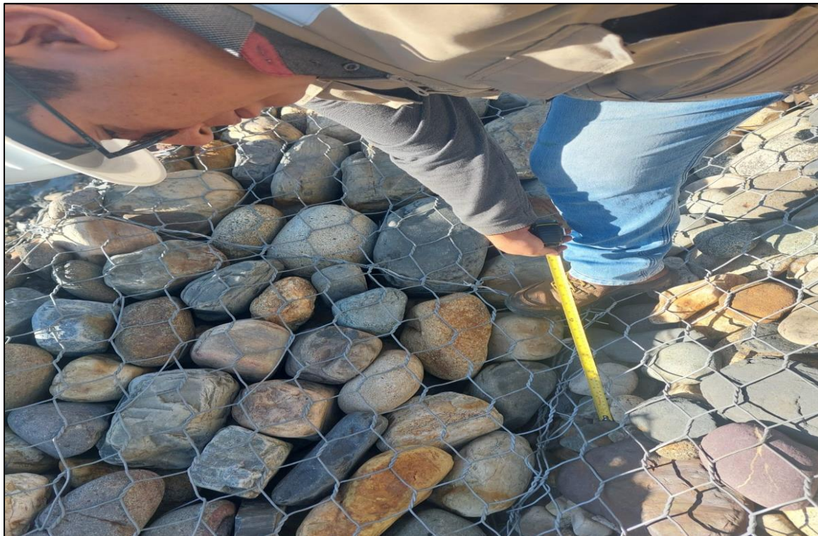
Descripción: Medición y roturas del material de relleno, entre las progresivas 0+040 y 0+060.
