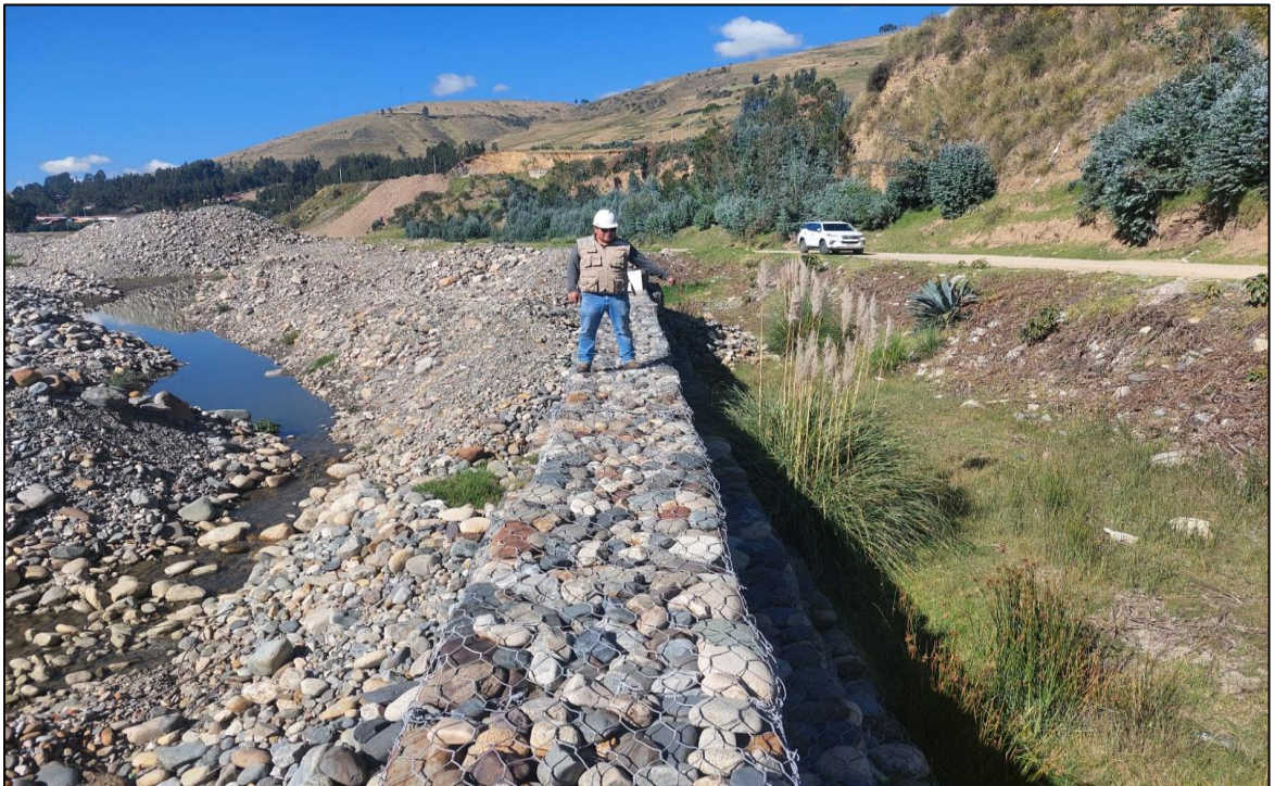
Descripción: Acumulación continua de sedimentos y vegetación, cubriendo completamente los dos primeros niveles del muro de gaviones entre las progresivas 0+080 y 0+100.
