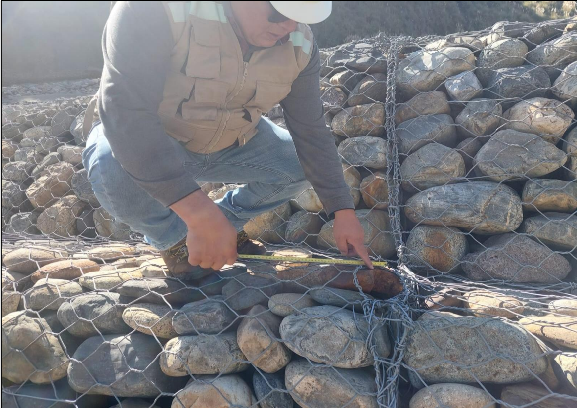
Descripción: Deformaciones en gaviones, entre las progresivas 0+040 y 0+060.
