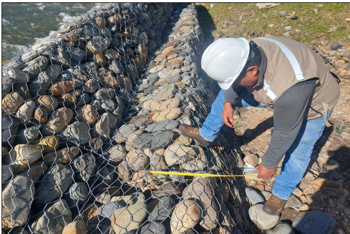
Descripción: Medición y roturas de la malla, entre las progresivas 0+040 y 0+060.
