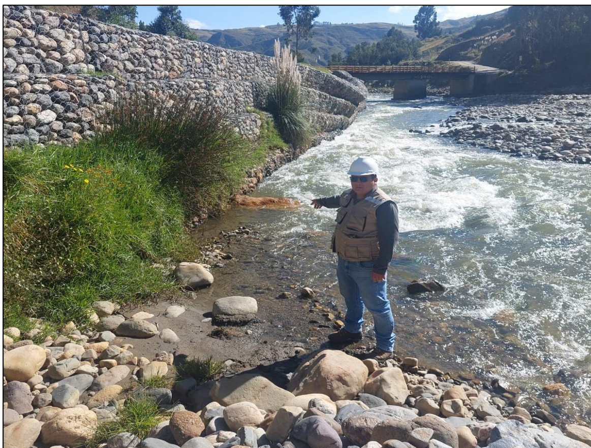
Descripción: Vista del asentamiento y el vuelco progresivo del muro de gaviones del río Santa en el puente Alegre.
