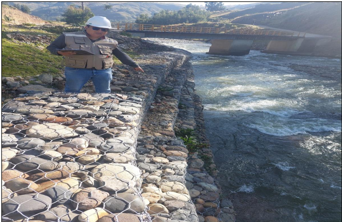
Descripción: Asentamiento, vegetación y falta de colchones antisocavantes, entre las progresivas 0+040 y 0+060.
