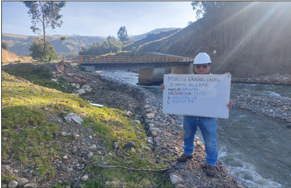
Descripción: Progresiva 0+020 del muro de gaviones del río Santa en el puente Alegre.
