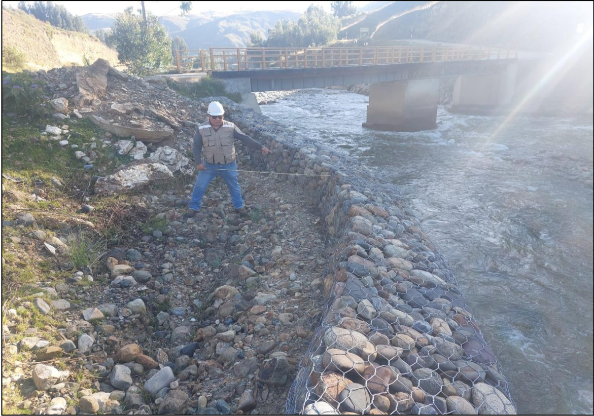
Descripción: Asentamiento por socavación causado por el flujo del río y desplazamiento de 1.70 m de la parte superior del muro.
