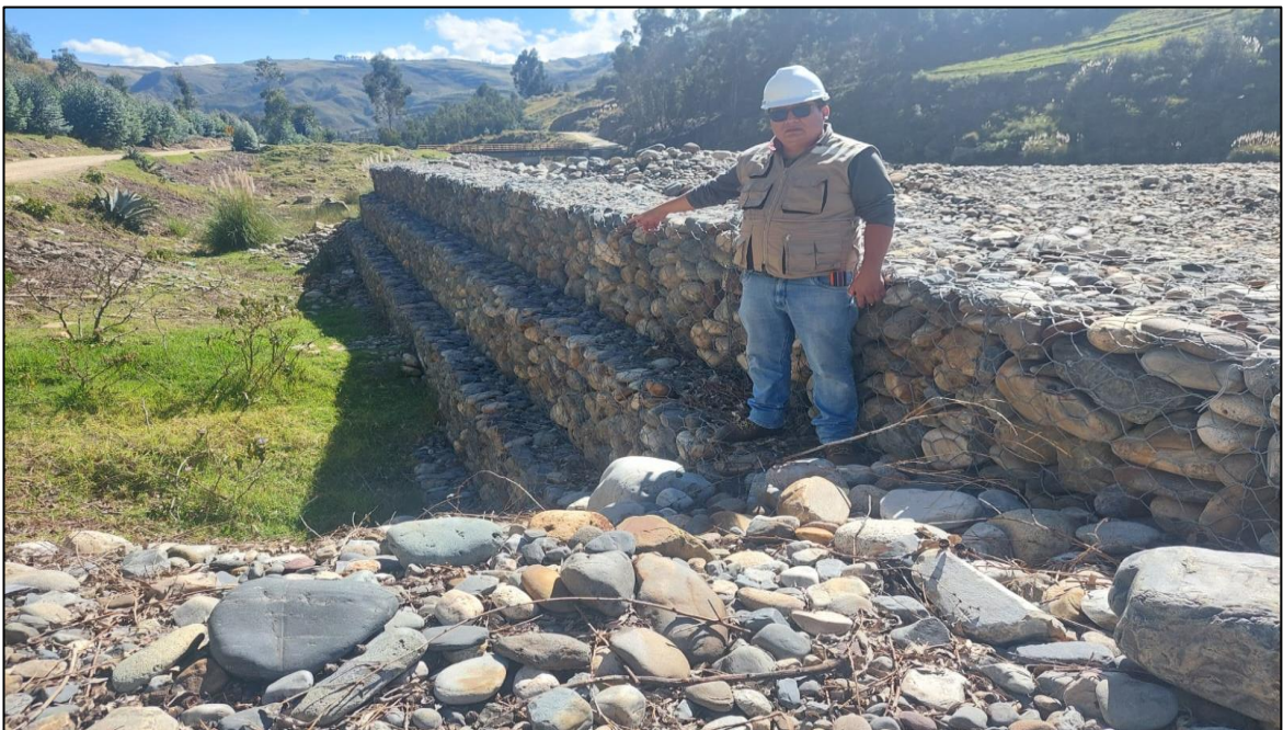
Descripción: Vegetación en el primer nivel del muro de gaviones, entre las progresivas 0+120 y 0+140.
