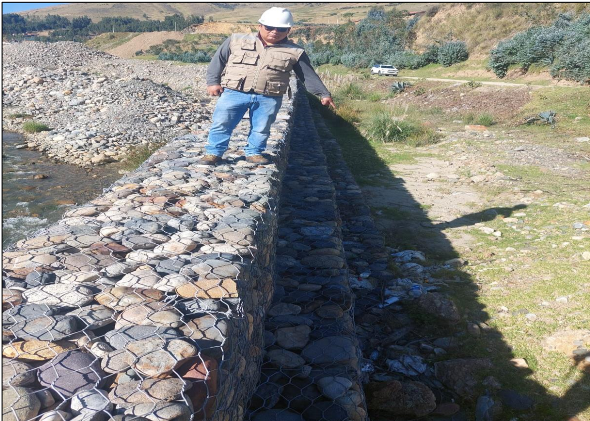
Descripción: Presencia de residuos sólidos entre las progresivas 0+060 y 0+080, vista 2.
