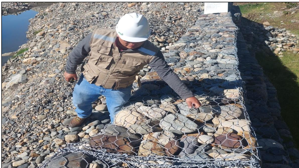
Descripción: Falta del material de relleno y deformaciones continuas de los gaviones, entre las progresivas 0+080 y 0+100
