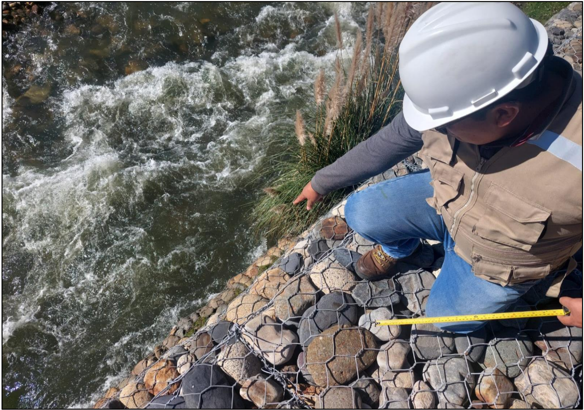
Descripción: Falta de colchones antisocavantes, entre las progresivas 0+060 y 0+080.
