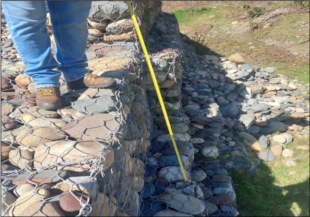
Descripción: Medición y roturas del material de relleno, entre las progresivas 0+100 y 0+120.
