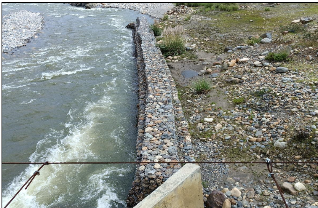
Fotografía N° 07: Se puede visualizar deformación en las dimensiones del muro de gaviones en la margen derecha.
