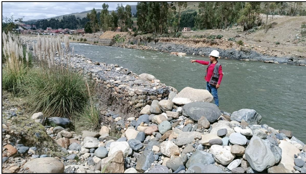
Fotografía N° 06: Se observa crecida de vegetación en el muro de gaviones en la margen derecha.
