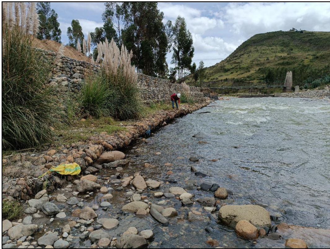
Fotografía N° 15: Tomando medidas de la altura de socavación en el muro de gaviones de tipo colchón de la margen izquierda.
