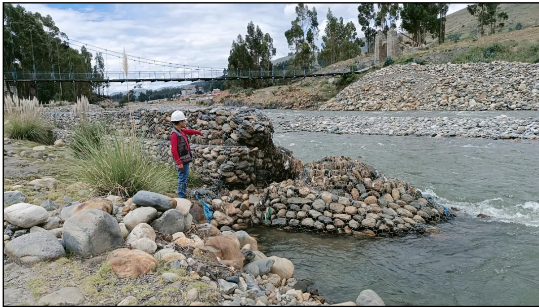
Fotografía N° 02: Se observa el desplome del muro de gaviones en la margen derecha.
