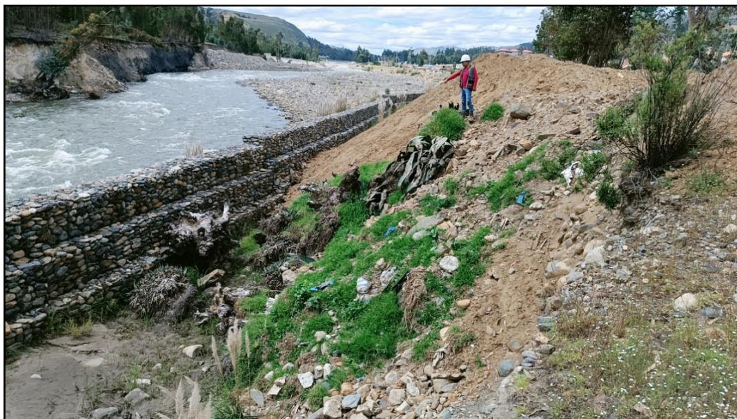
Fotografía N° 09: Se observa desmonte y vegetación en el muro de gaviones de la margen izquierda.
