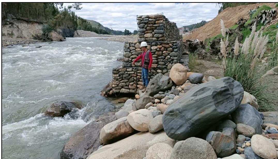
Fotografía N° 10: Se observa socavación en el muro de gaviones de la margen izquierda.
