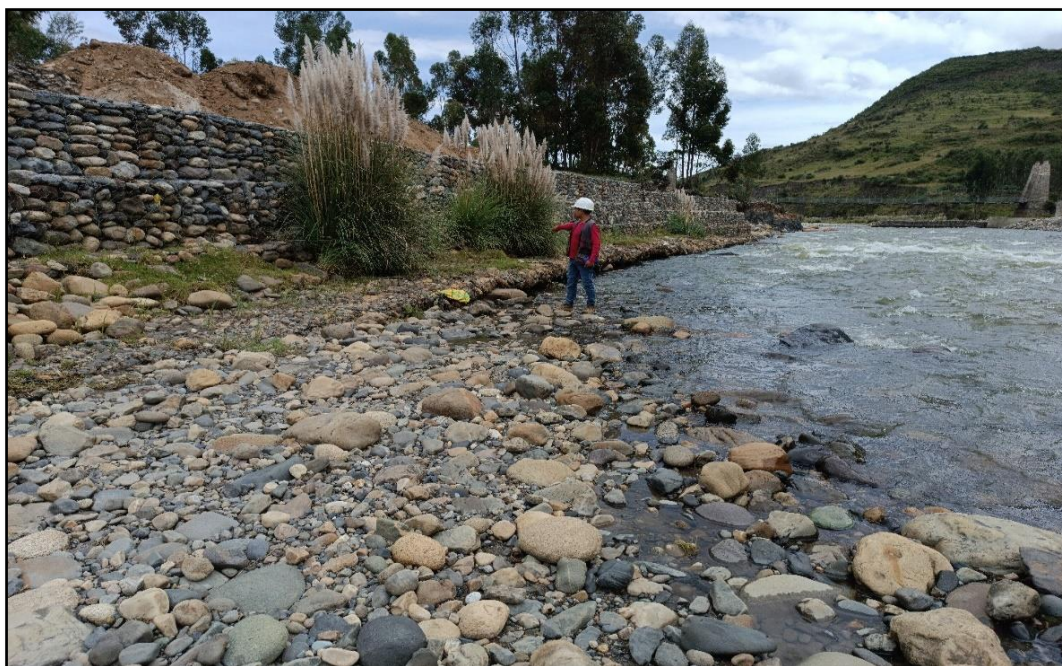
Fotografía N° 13: Se puede observar socavación en el muro de gaviones de tipo colchón de la margen izquierda.
