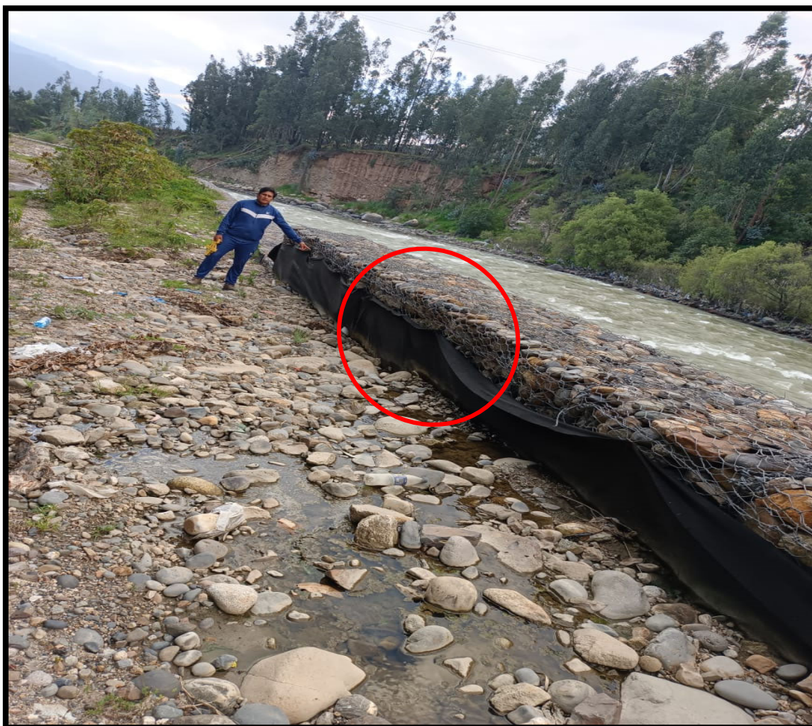
Figura 14 Geotextil expuesto a la intemperie
