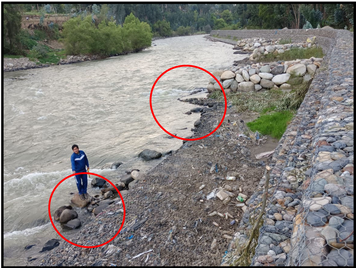
Figura 16 Socavación del colchón reno
