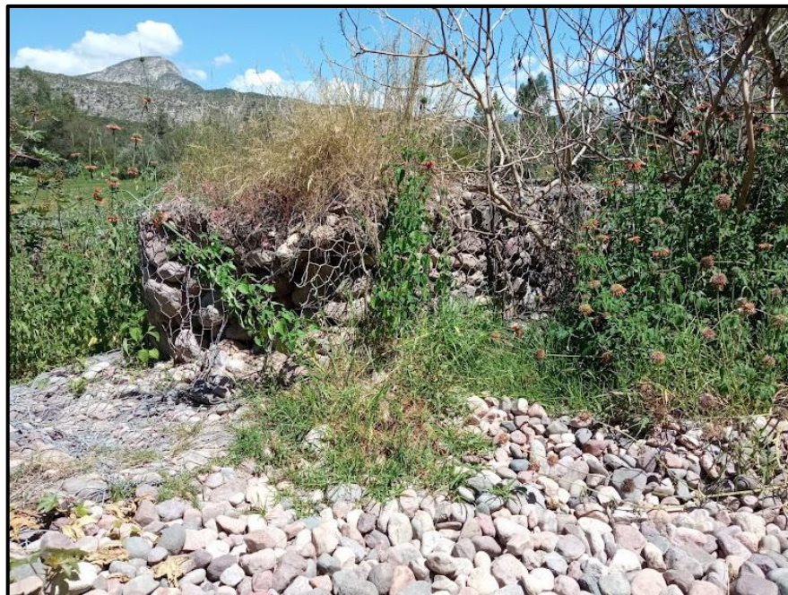
Figura 20: Rotura de la malla y deprendiendo del relleno
