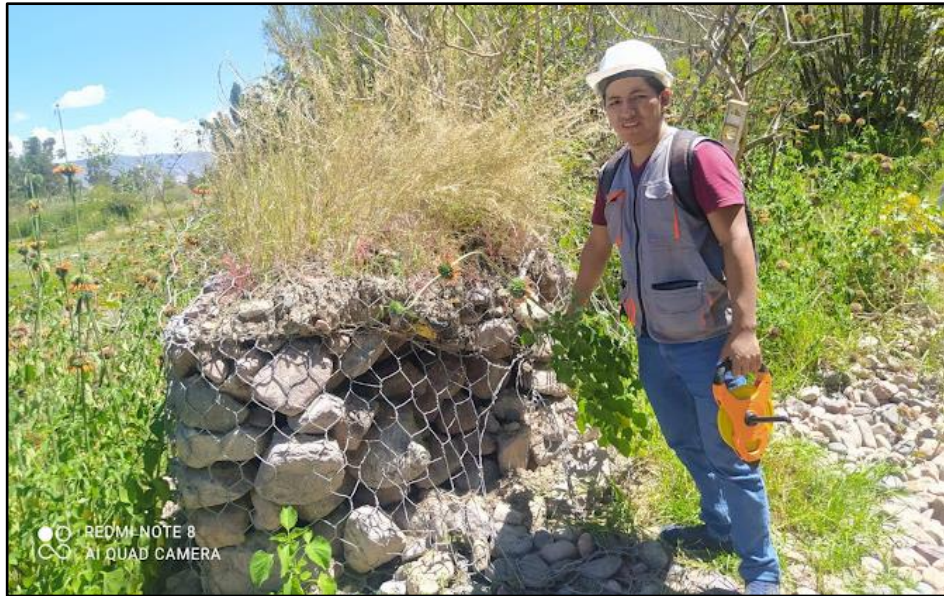
Figura 13: Rotura de malla de gavión en muro
