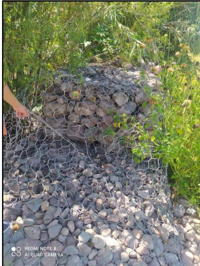
Figura 19: Rotura del gavión y deprendiendo del relleno
