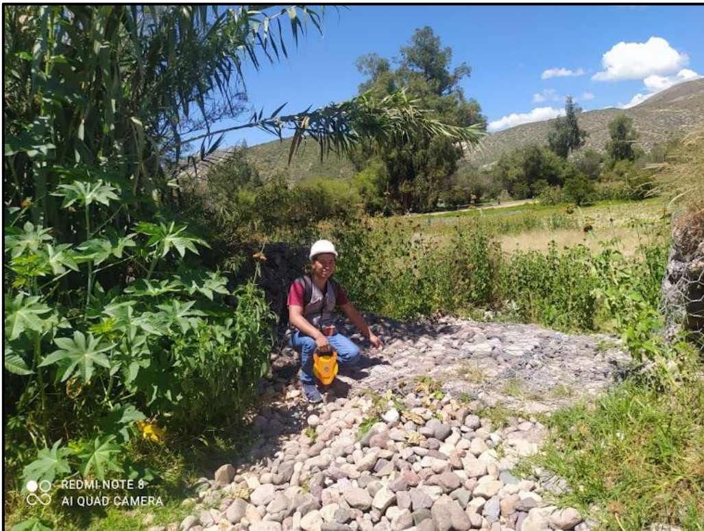
Figura 24: Gaviones incompletos en el muro de gavión
