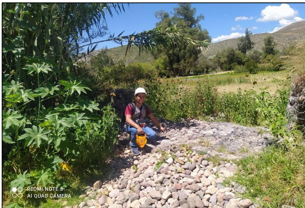
Figura 12: Gaviones incompletos en muro de aviones
