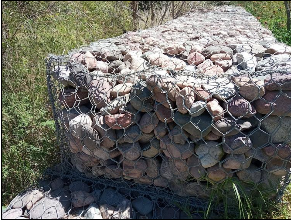
Figura 25: Desprendimiento de relleno en el muro de gavión
