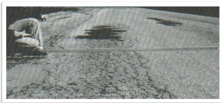
Figura 2.4: piel de cocodrilo –nivel de severidad –alta
