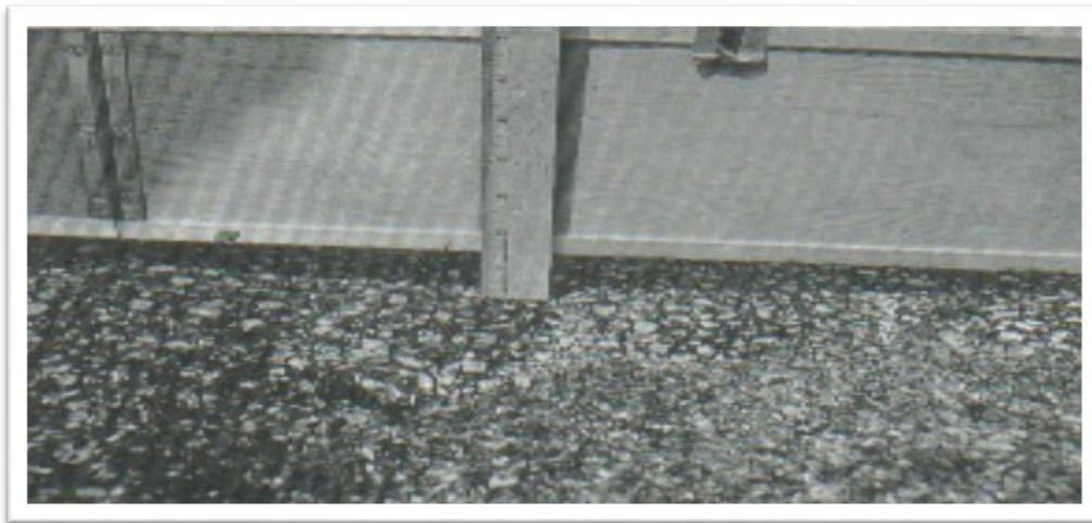
Figura 2.18 ahuellamiento de alta severidad.
