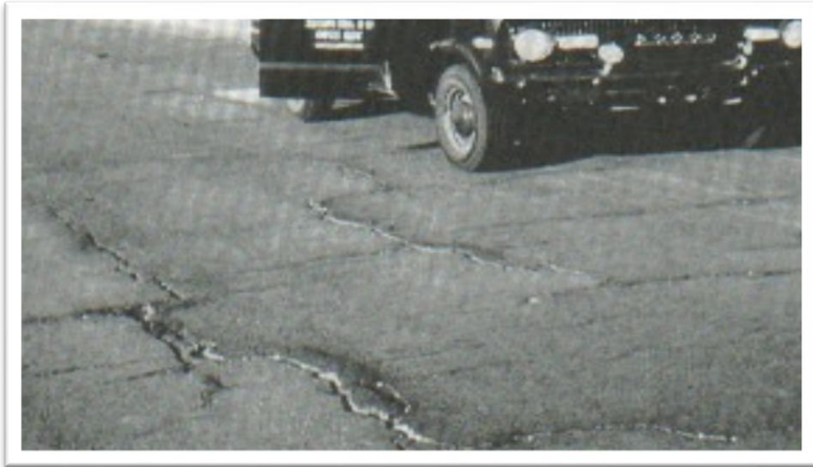
Figura 2.6: Grietas en bloque de alta severidad.
