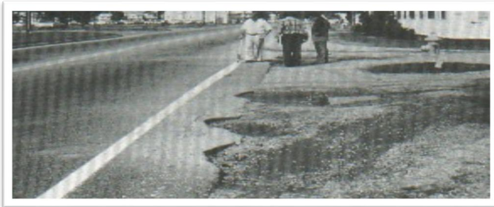
Figura 2.10. Grietas de borde alta severidad
