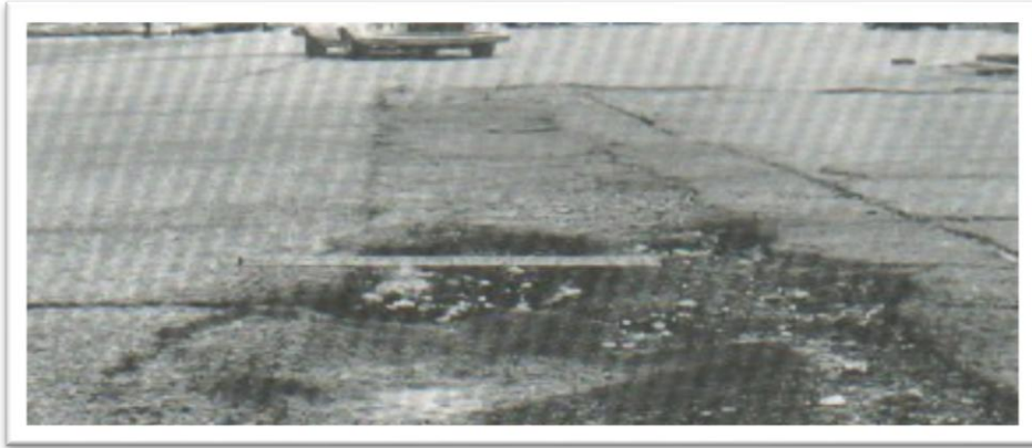
Figura 2.14 parcheo de alta severidad.
