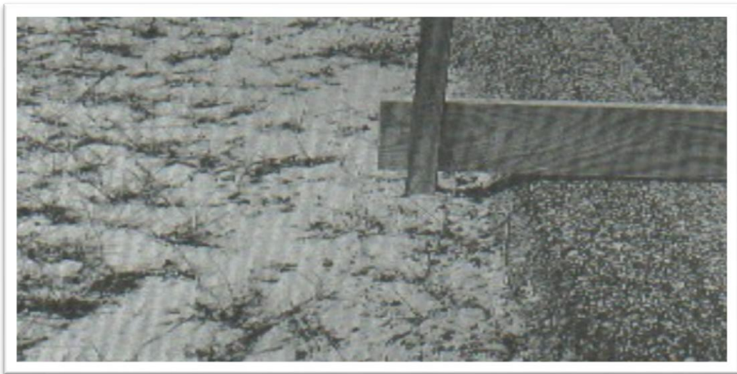
Figura 2.12. desnivel de carril/berma alta severidad
