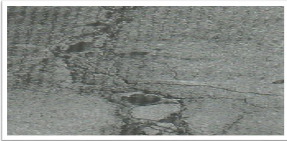
Figura 2.13 Grietas longitudinales y transversales de alta severidad.
