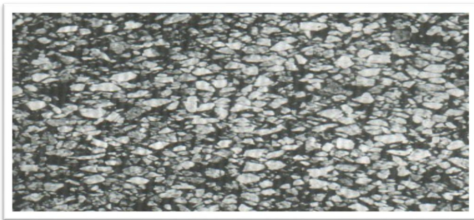
Figura 2.15 pulimiento de agregados de alta severidad.
