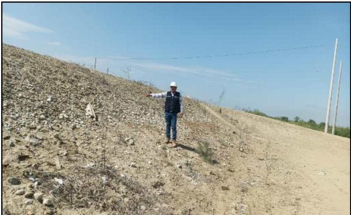
Figura 14: presencia de algunas ramas en el talud del dique.
