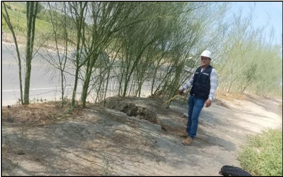
Figura 9: se observa la rotura del dique en la progresiva 0+500 - 0+550.
