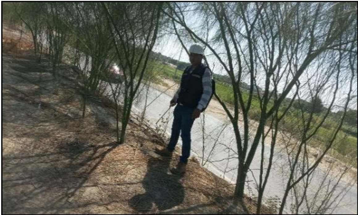
Figura 5: Se identifica el crecimiento de plantas de tallos altos, causando grietas debido a sus raíces.
