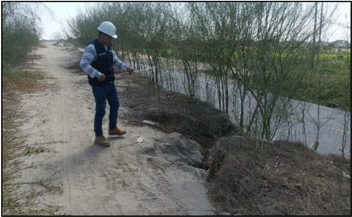
Figura 7: identificación de grieta en la progresiva 0+300 - 0+350.
