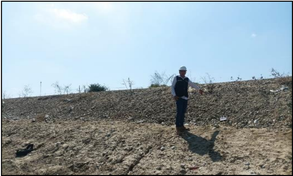
Figura 15: evaluación del talud, presencia de fisuras
