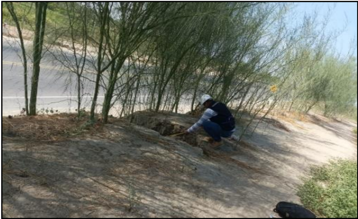
Figura 3: Identificación de la grieta de la progresiva 0+100 - 0+150.
