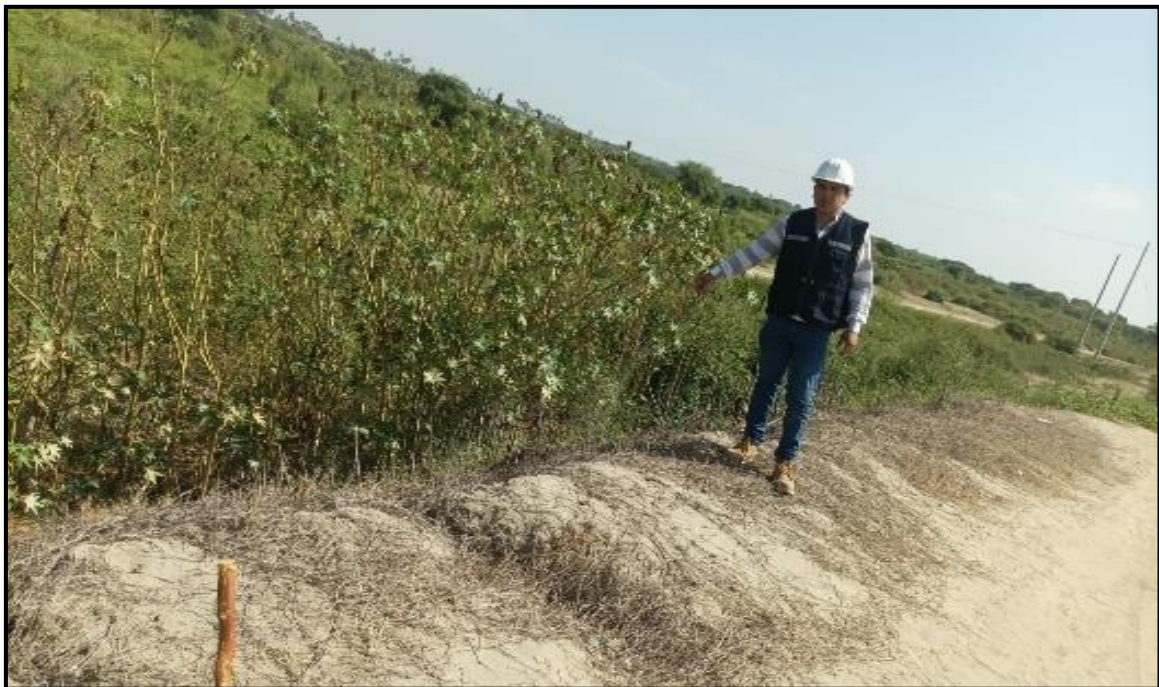
Figura 10: presencia de vegetación, ramas que recubren la defensa ribereña.
