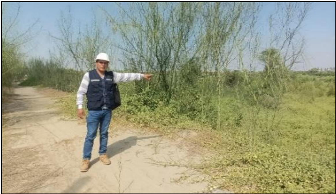
Figura 2: Observación de vegetación y plantas de tallos altos en la corona del dique.
