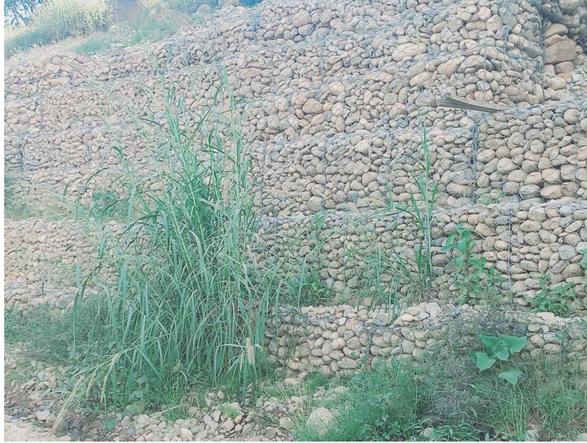
Figura 7: Se observa maleza alrededor de muro de gaviones
