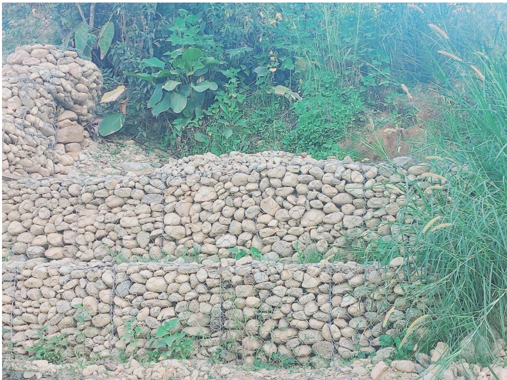
Figura 6: Deficiencia encontrada en el muro de gaviones
