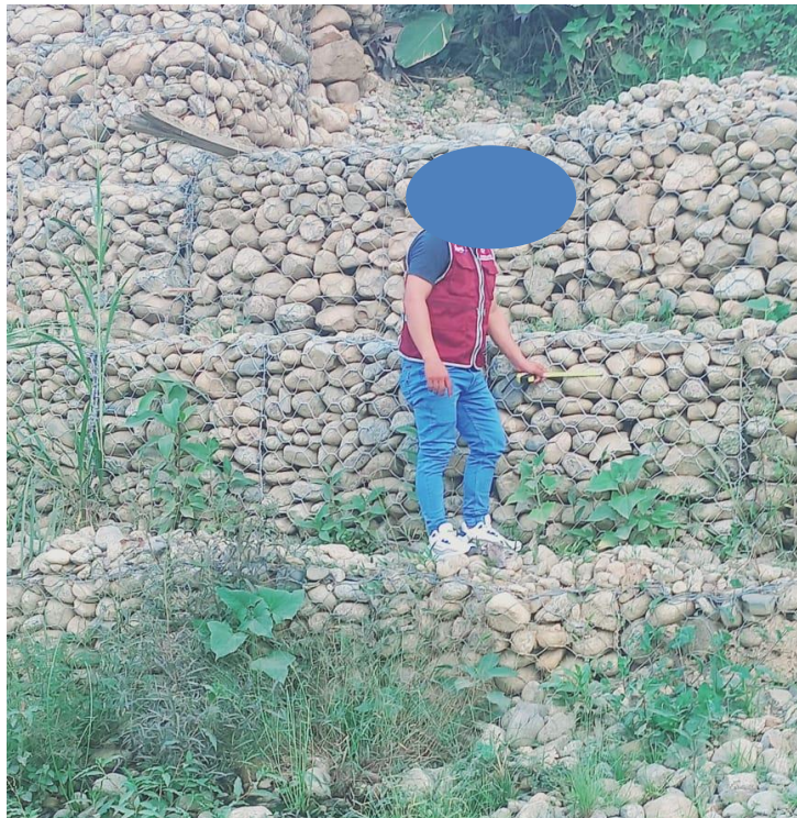
Figura 4: Realizando la medición de las rocas usadas en los muros de gaviones
