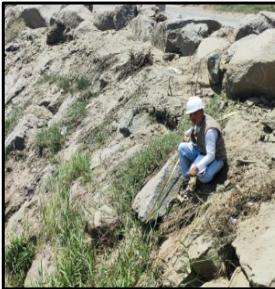
Medición de la Infraestructura del Enrocado, se observa el desprendimiento del mismo.
