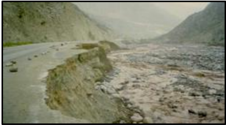
Figura 5 Socavación en la margen de un río. Fuente: Alfredo Blanco
