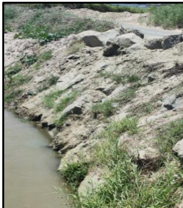
Fotografía 2 Crecimiento de vegetación en el enrocado
