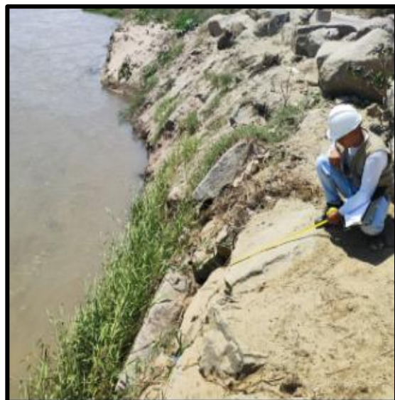
Se observa el desprendimiento del Enrocado.
