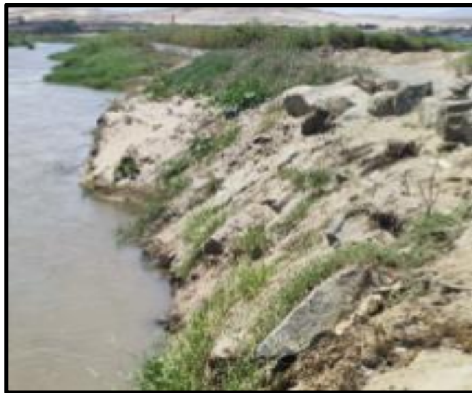
Fotografía 6 Se observa el desprendimiento del Enrocado
