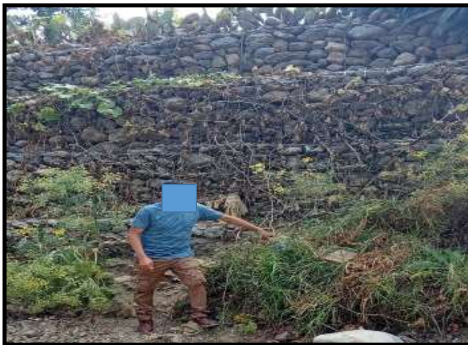
Figura N°15: Se muestra vegetacion y malezas en el contorno de muro de gaviones
