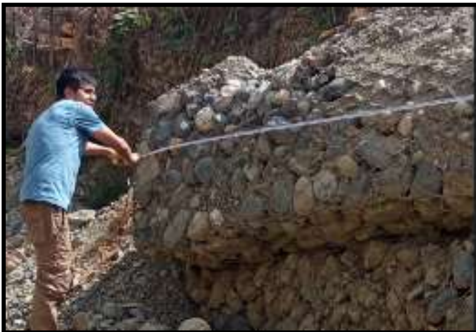
Figura N°18: Colapso del muro de gaviones de 10m de longitud
