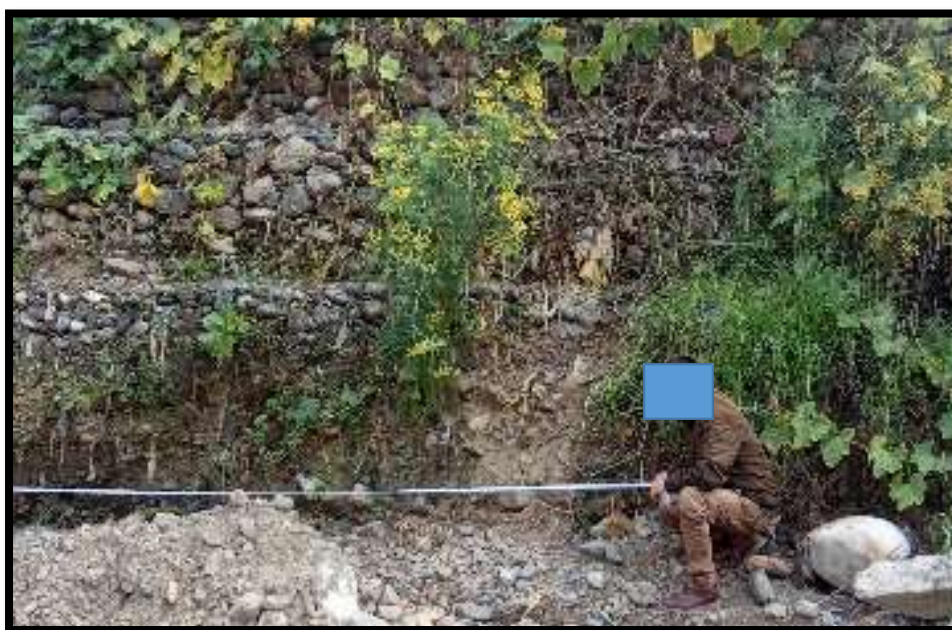
Figura N°16: Se realiza la medición de la erosión en la base de muro de gaviones
