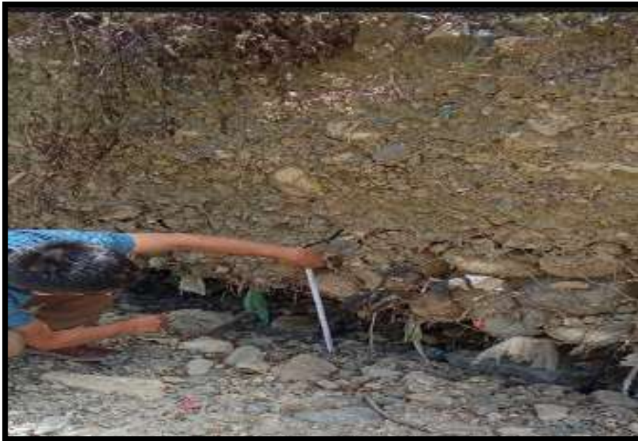
Figura N°17: Medicion de socavación en la base del muro de gaviones
