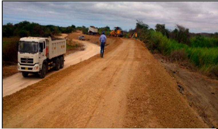
Figura 5. Trabajos de protección en cinco diques del río Chira: extraído de publicación de RPP (internet).
