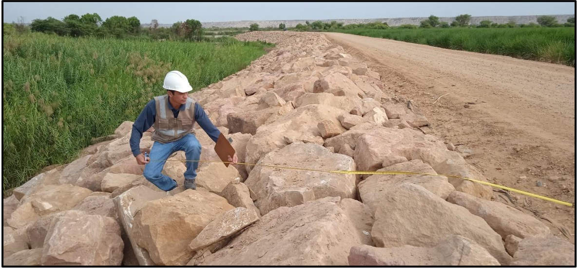
FOTOGRAFIA 14: Medición de ancho de enrocado sobre talud, tramo mejorado progresiva 4+400 a 4+800, (tomada el 09/05/2024).
