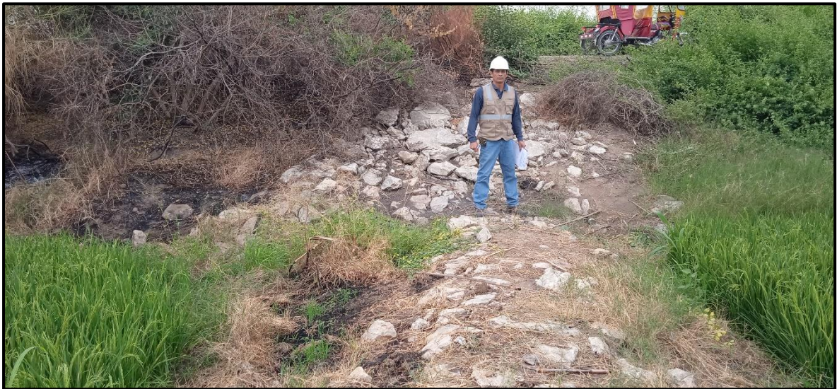
FOTOGRAFIA 11: Verificando condiciones del espigón de cabeza, (tomada el 09/05/2024).
