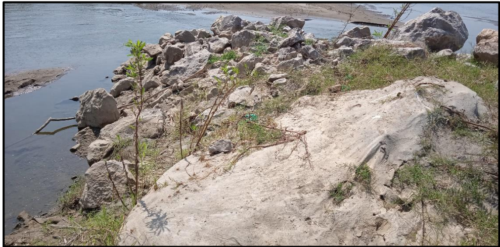
FOTOGRAFIA 01: Restos de espigón destruido por el río, perteneció al anterior tramo del dique que fue erosionado por las aguas turbulentas en época del fenómeno el niño (tomada el 13/04/2024).
