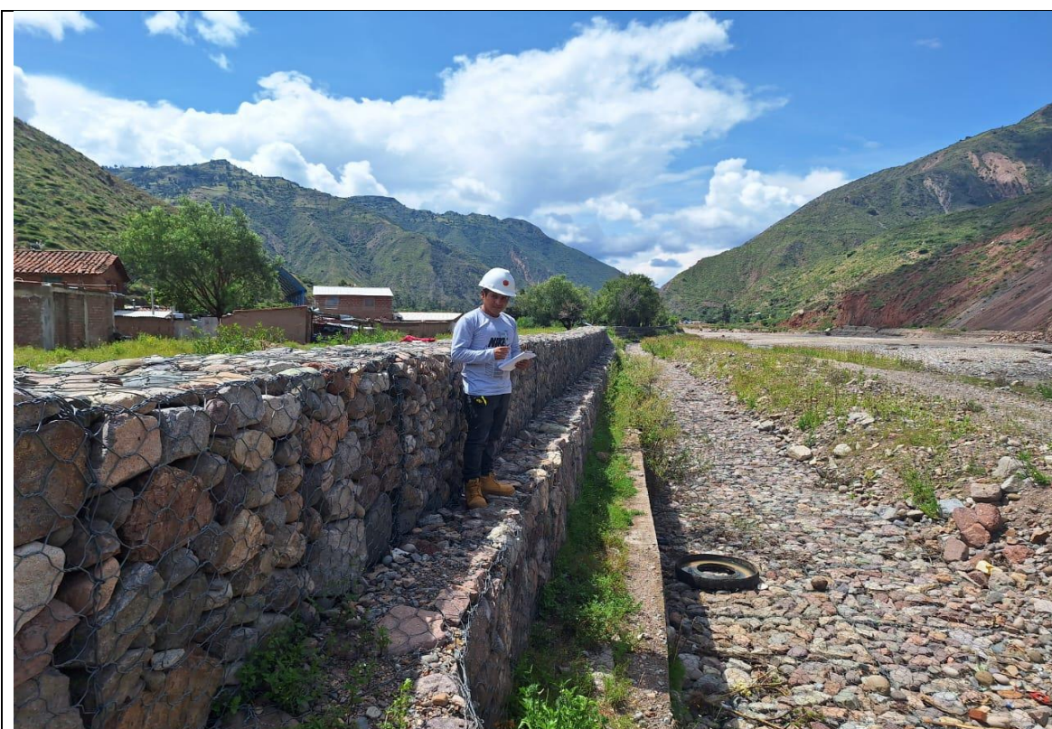
Foto N°6: se observa exceso de vegetación alrededor de la estructura
