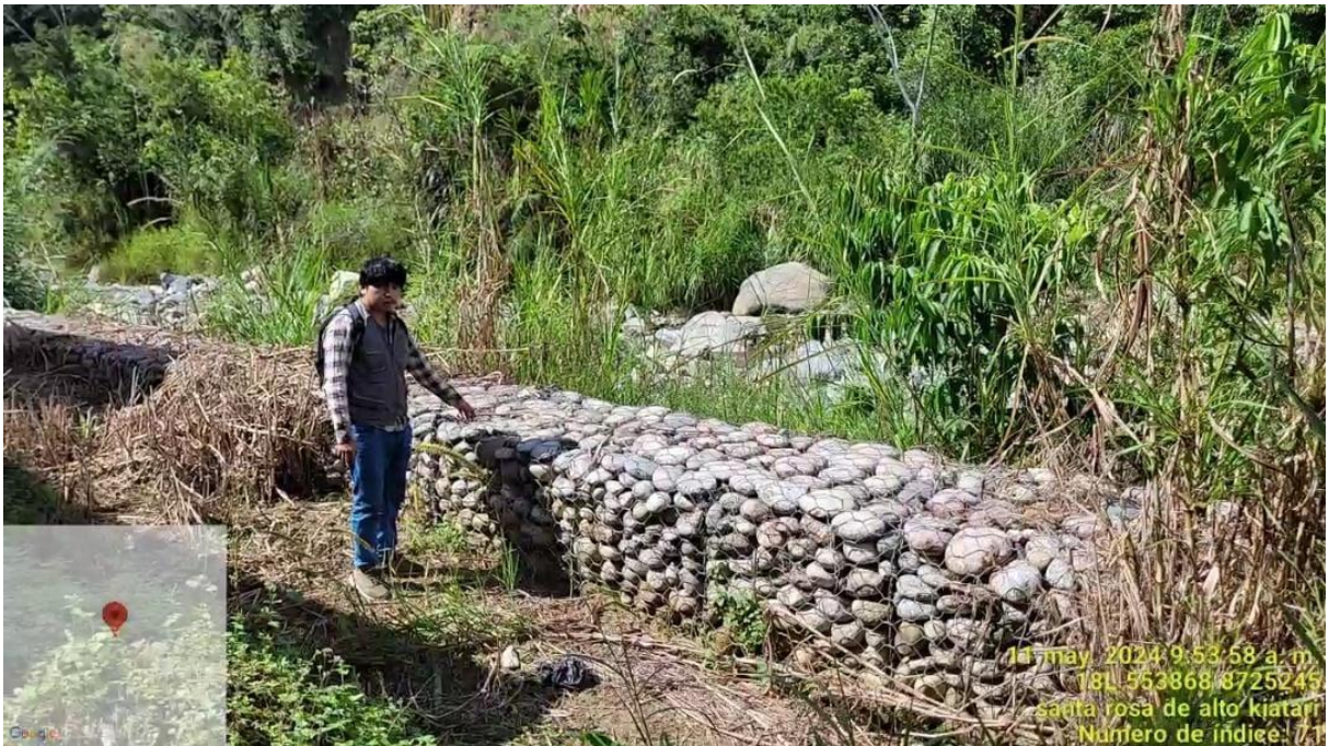
Figura 13: Malla de alambre galvanizada corroída.
