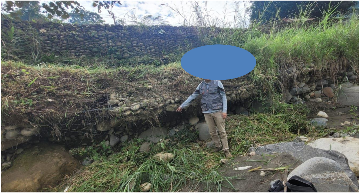
Figura 12: Muro de gavión con socavación
