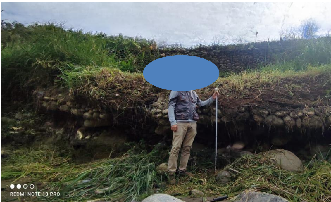
Figura 15: Altura de socavaci3n sobre el muro de gavi3n.
