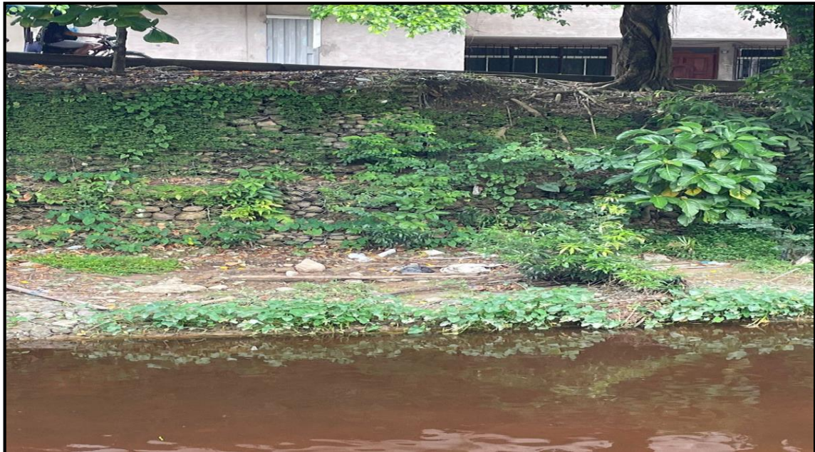
Figura 7: Desmonte y basura al rededor del gavi3n
