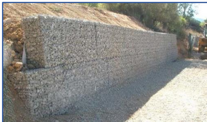
Figura 12: Gaviones para protección de taludes. Obtenido del libro Vásquez et al (14).
