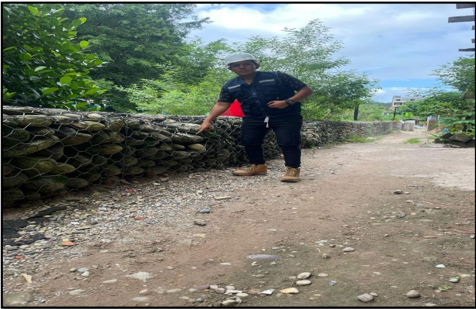
Figura 9: Punto de deficiencia del Muro de gaviones
