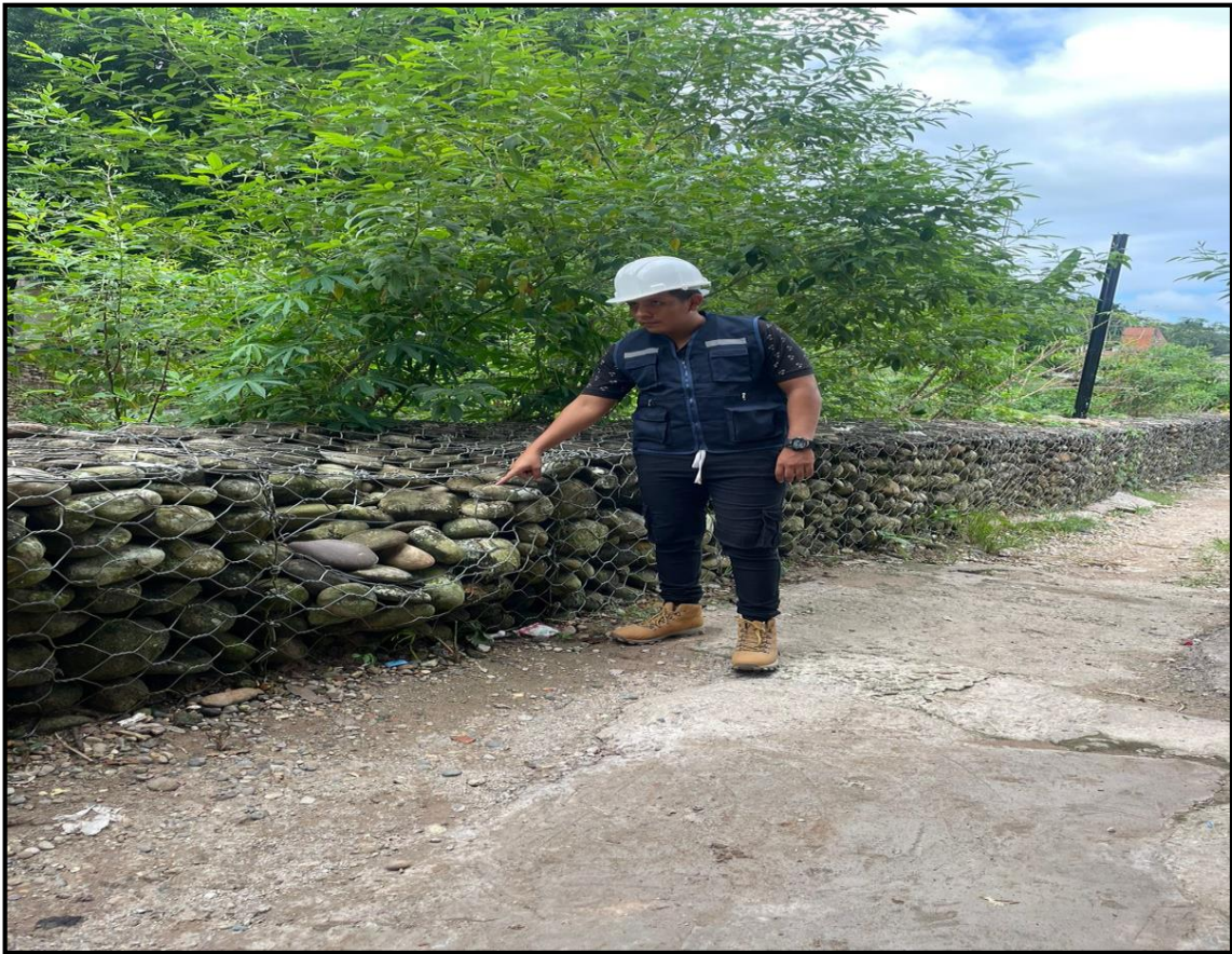
Figura 8: Malla rota de los gaviones
