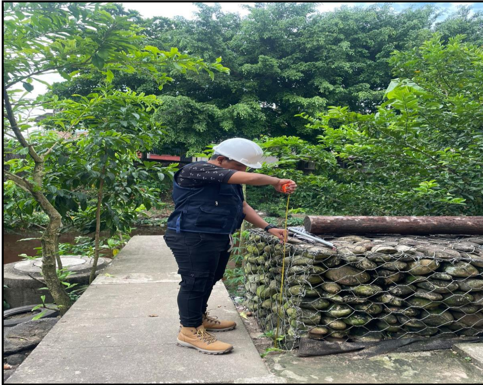
Figura 6: Desmonte y basura al rededor del gavi3n
