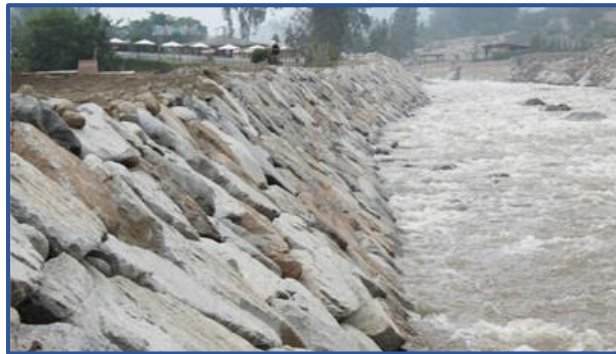
Figura 19: Revestimiento en enrocado. Obtenido del libro Almedia (15).
