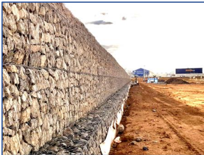
Figura 14: Muro de contención de gaviones. Obtenido del libro Vásquez et al (14).
