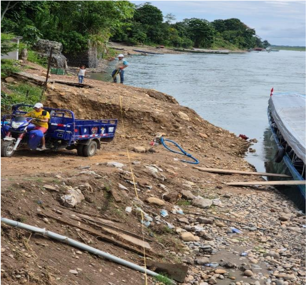
Figura 11: Toma de medida del muro derrumbado
