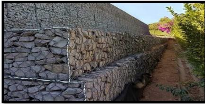
Figura 6: Muros de gaviones
