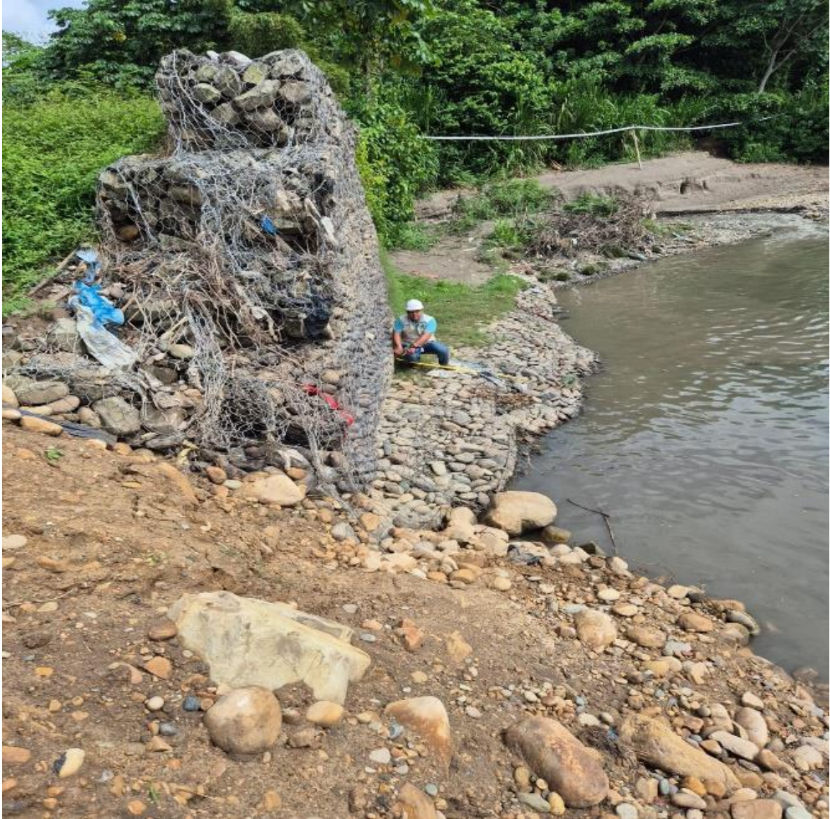
Figura 13: Se observa el muro debilitado
