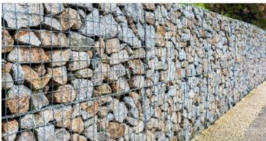
Imagen 1: estructura con gaviones
