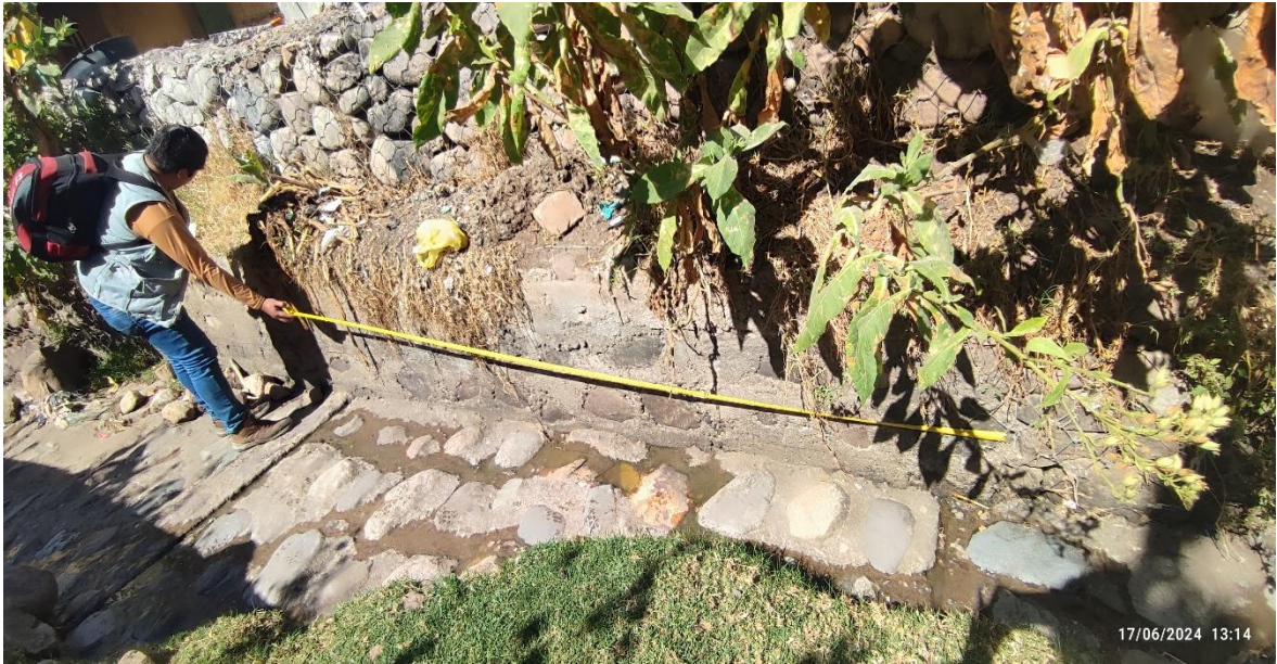
Imagen 22: presencia de cambio de la malla por concreto en el muro de gaviones. Fuente: imagen propio
