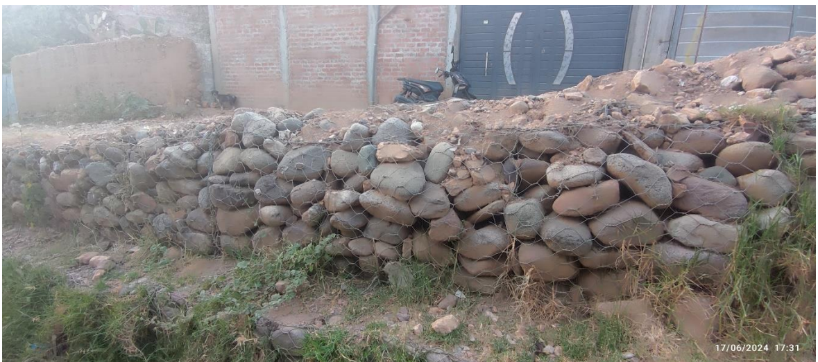
Imagen 27: presencia de pérdida de roca de la malla y deformación en el muro de gaviones. Fuente: imagen propio
