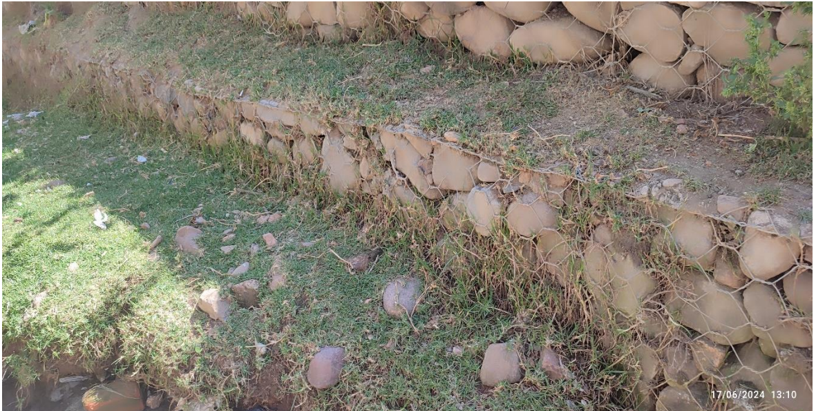
Imagen 21: presencia de acumulación de desmostes (pastos) en el muro de gaviones.
