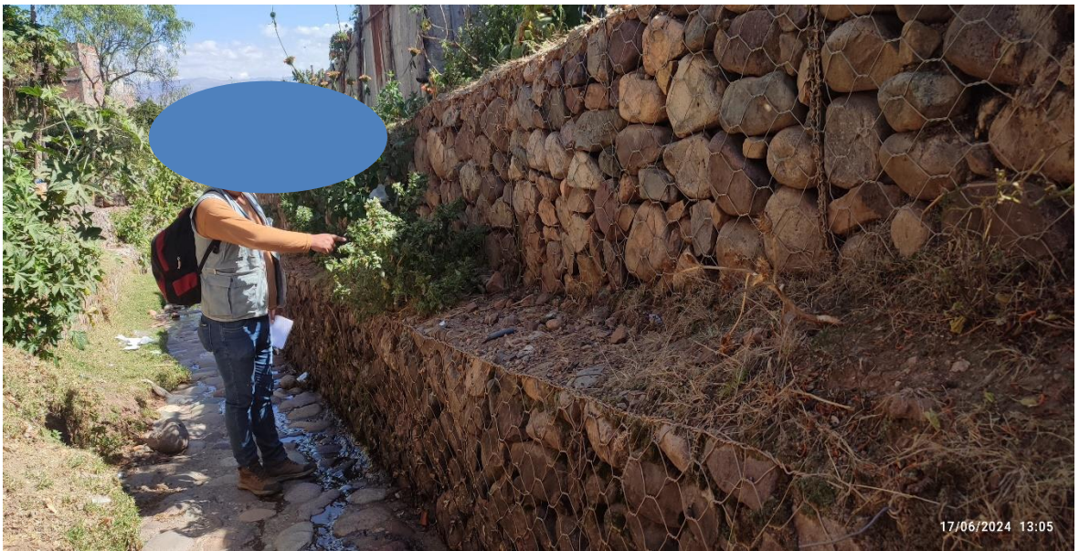
Imagen 19: presencia de arbustos en el muro de gaviones. Fuente: imagen propio
