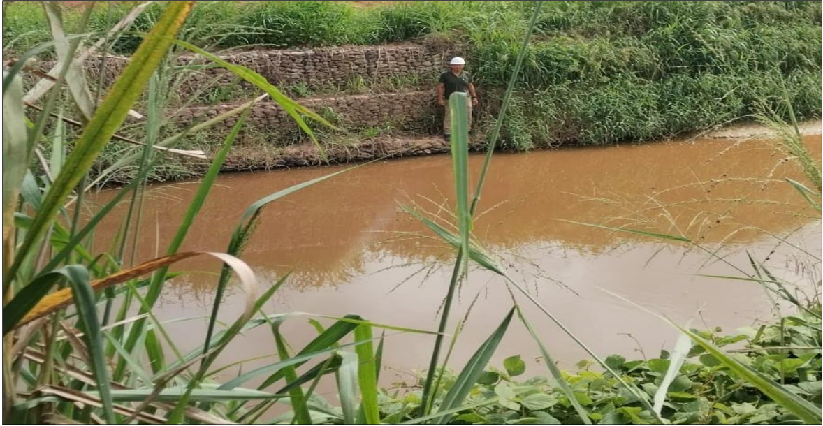
Figura 13: Se aprecia socavación en la progresiva 0+030
