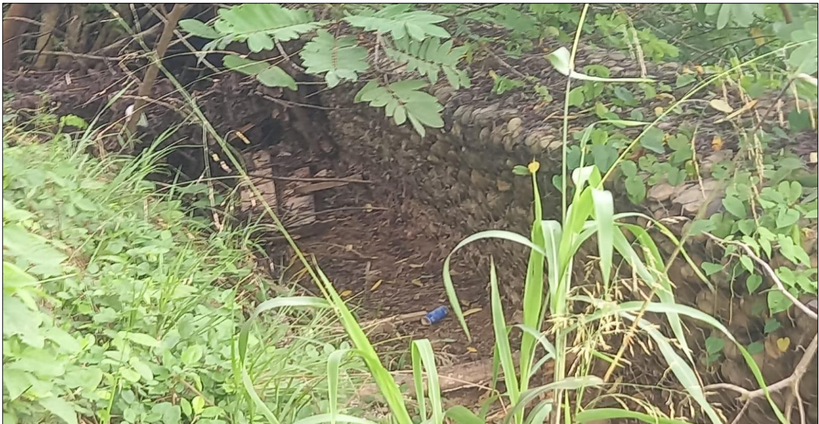
Figura 12: Se aprecia desperdicios de basuras en la progresiva 0+020
