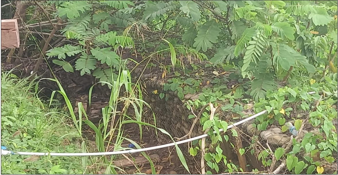
Figura 11: Se aprecia desechos de basura en la progresiva 0+010
