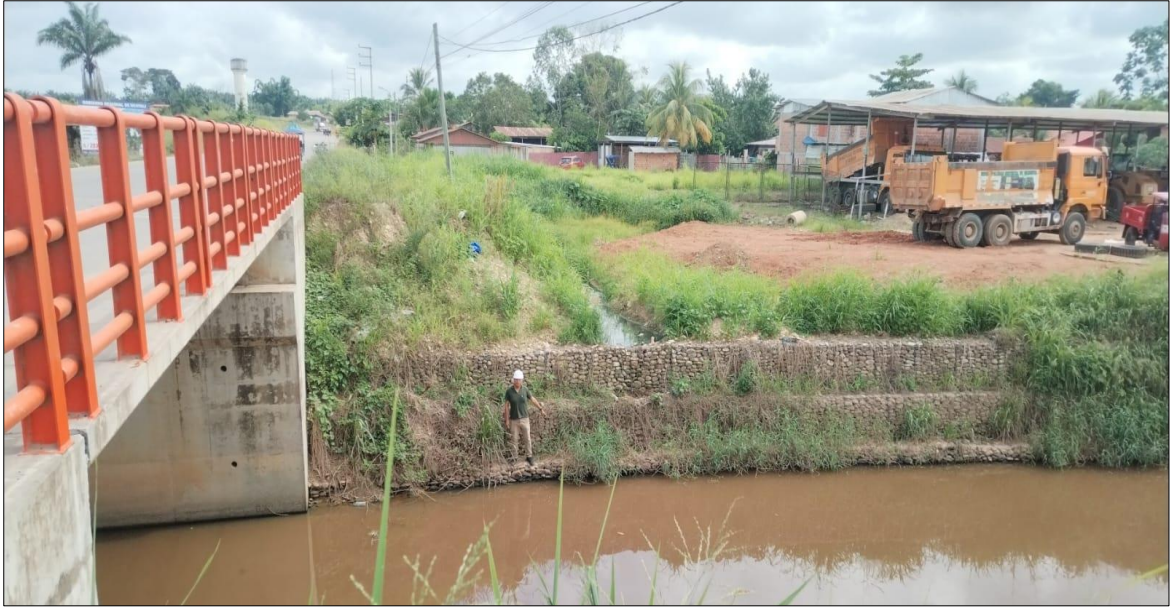
Figura 5: Muro de gavión de ambas margenes del río gran putilla
