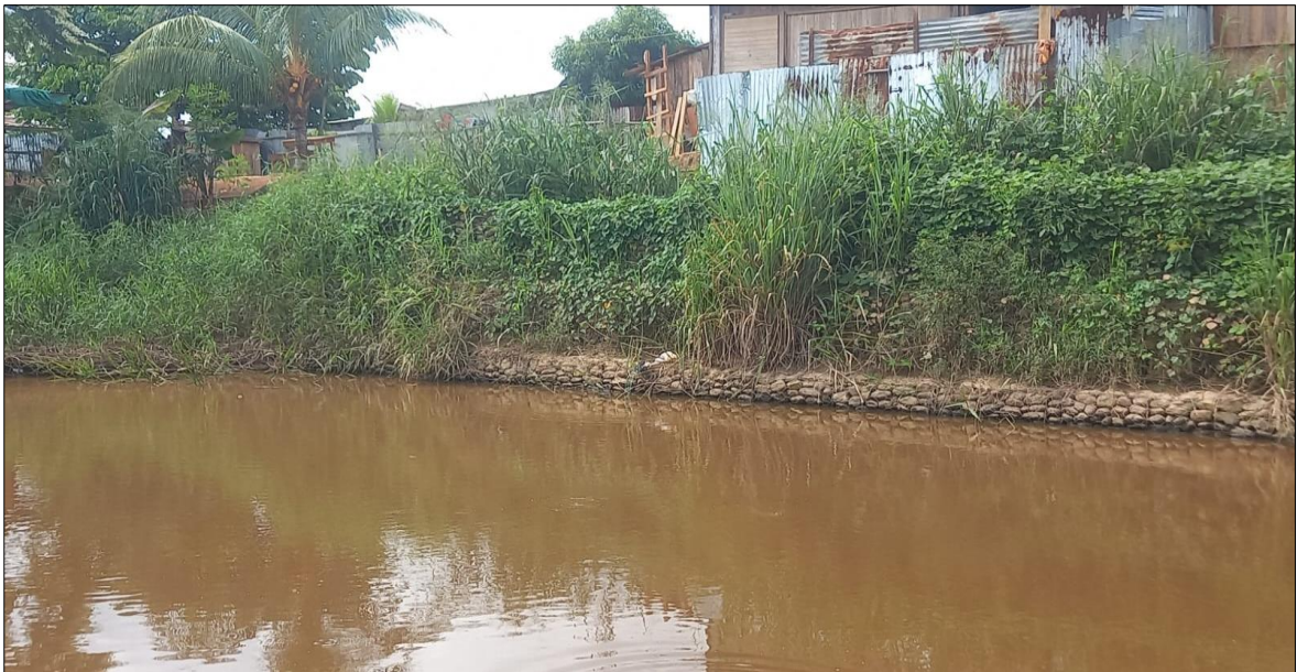
Figura 14: Se aprecia socavación en la progresiva 0+050
