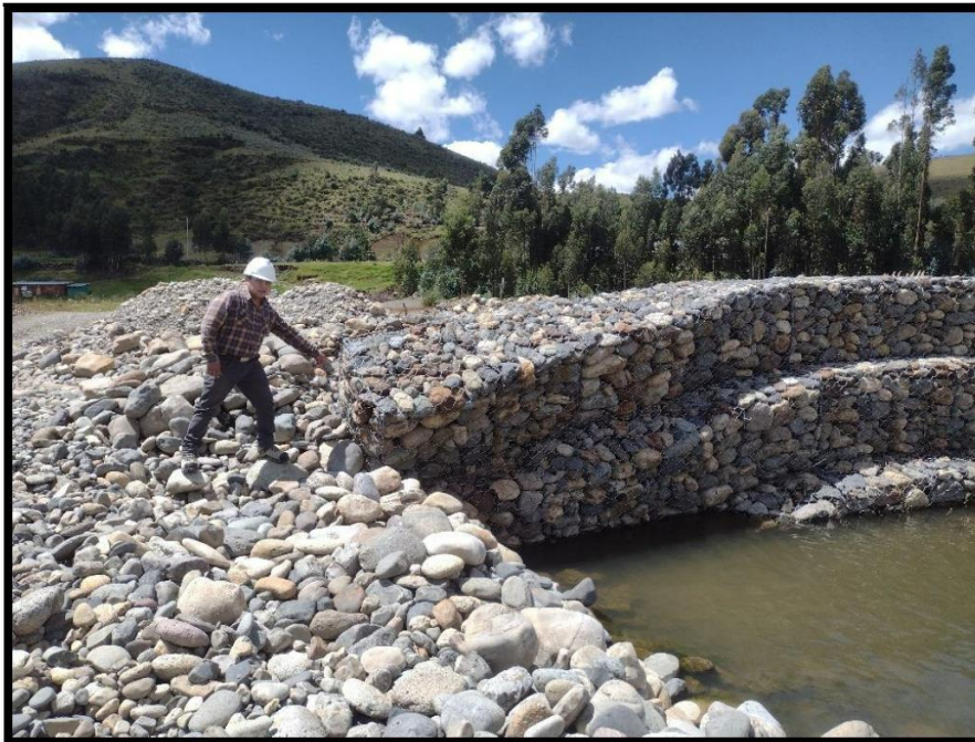
EN LA IMAGEN N° PODEMOS OBSERVAR EL PUENTO DE FINAL DE LA DEFENSA RIBEREÑA DONDE EL MURO DE GAVIONES A SIDO COLMATADO, ESTANCADO DE AGUA, FLEXIONADO
