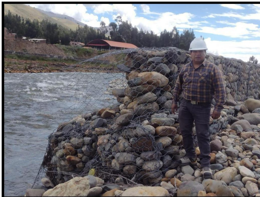
EN LA IMAGEN N° PODEMOS OBSERVAR EN LA PROGRESIVA 0+450 SE OSERVA PARTE DEL MURO DE GAVION QUE TODABIA EXISTE PERO AL IGUAL FUE ARRASADO Y DEBILITADO EN SU ESTRUCTURA POR LA SOCAVACION
