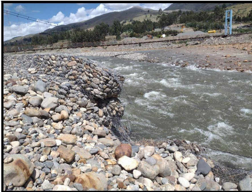
EN LA IMAGEN N° PODEMOS OBSERVAR RESTOS DE MALLA Y EL PRIMER NIVEL QUE ESTA COLMATADO CUBIERTO DE ESCOMBROS
