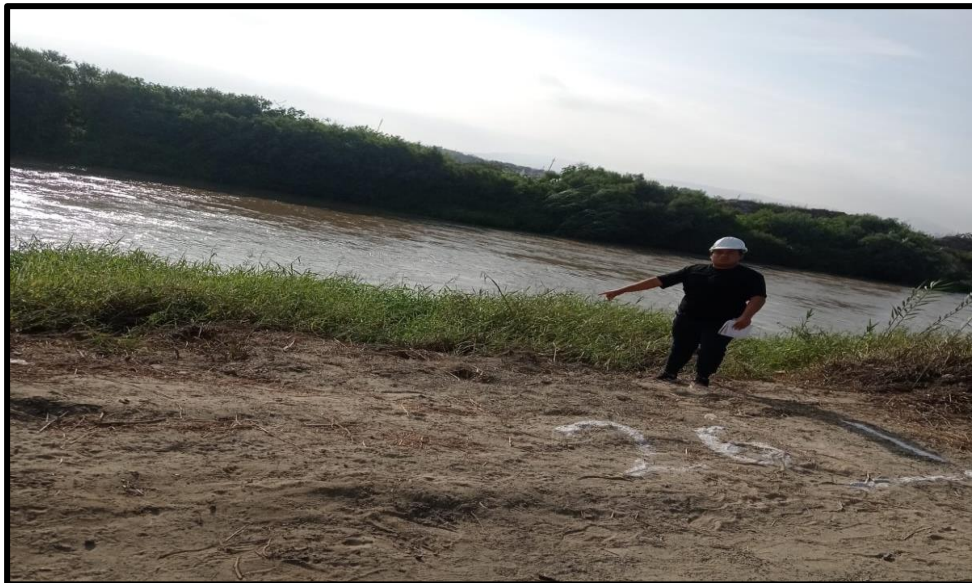
Figura 17: Zona deteriorada no existe enrocado
