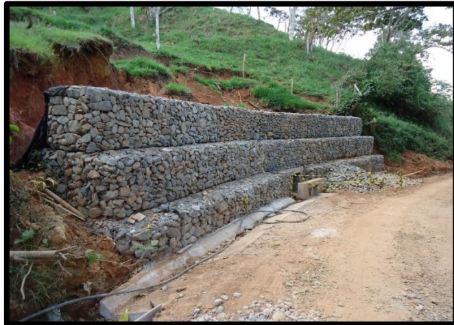
Figura 16: Deslizamiento muro de gavion
