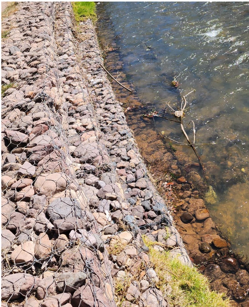
Figura 19: muro de gavion en el rio zaña
