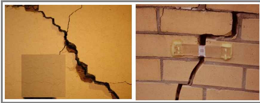
Imagen N° 8 Grietas en muros
