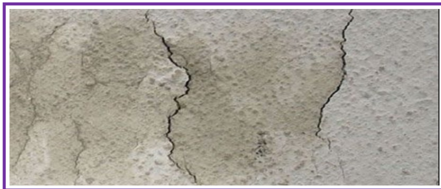
Imagen N° 1 Fisuras de asentamiento plástico
