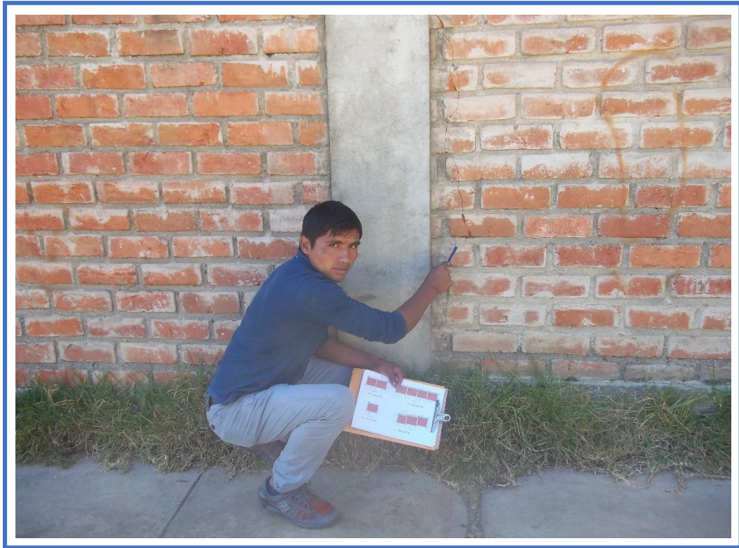
Imagen N° 13 Fotografía de Grietas en Muros
