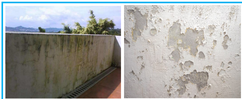
Imagen N° 3 Humedad por Infiltración
