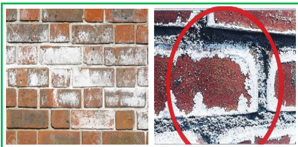
Imagen N° 6 Eflorescencias producidas por la humedad y sulfatos
