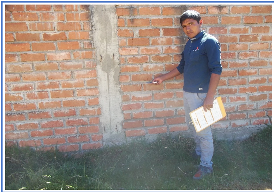
Imagen N° 14 Fotografía de Fisuras en Muros
