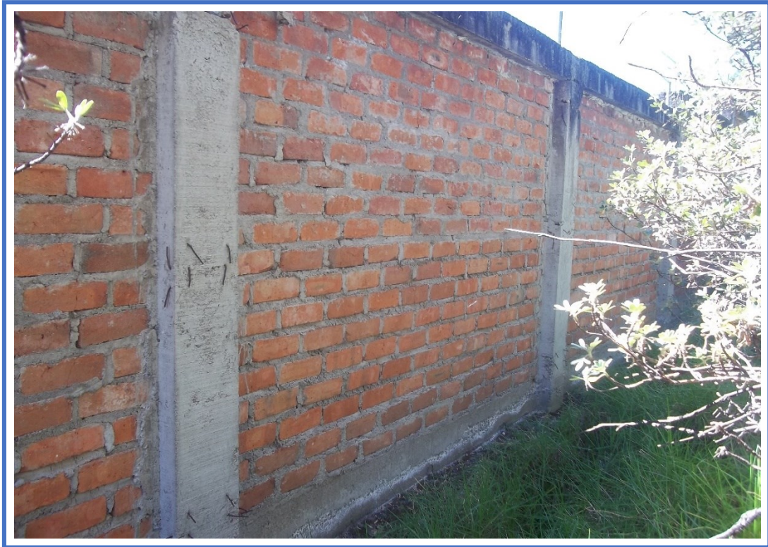
Imagen N° 15 Fotografía de Eflorescencia en Sobrecimiento
