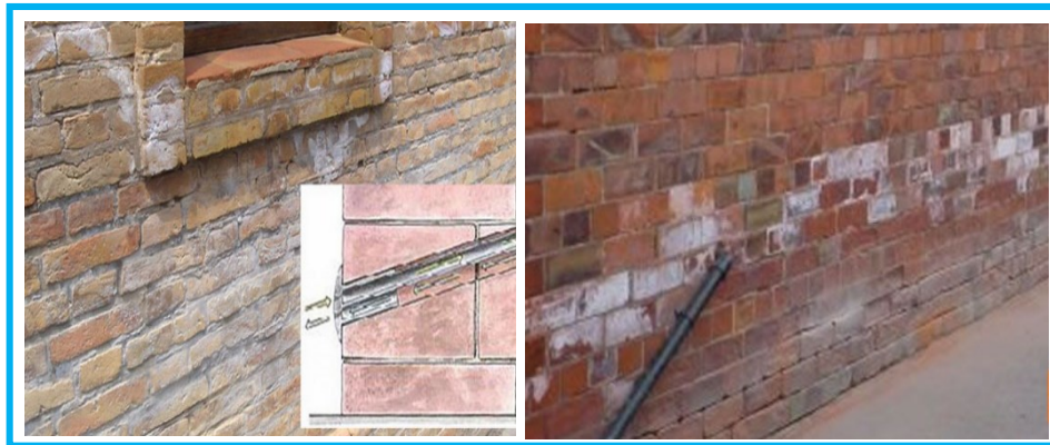
Imagen N° 4 Humedad por Capilaridad
