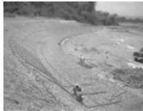
Fig. 9.16 Venezuela: protección de revestimiento de colchones Reno® con concreto variado en construcción
