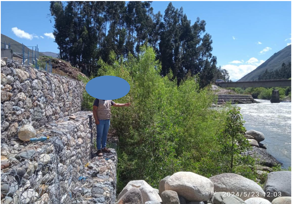
Figura 14: Malezas sobre el muro de gaviones Fuente: Evidencia de campo
