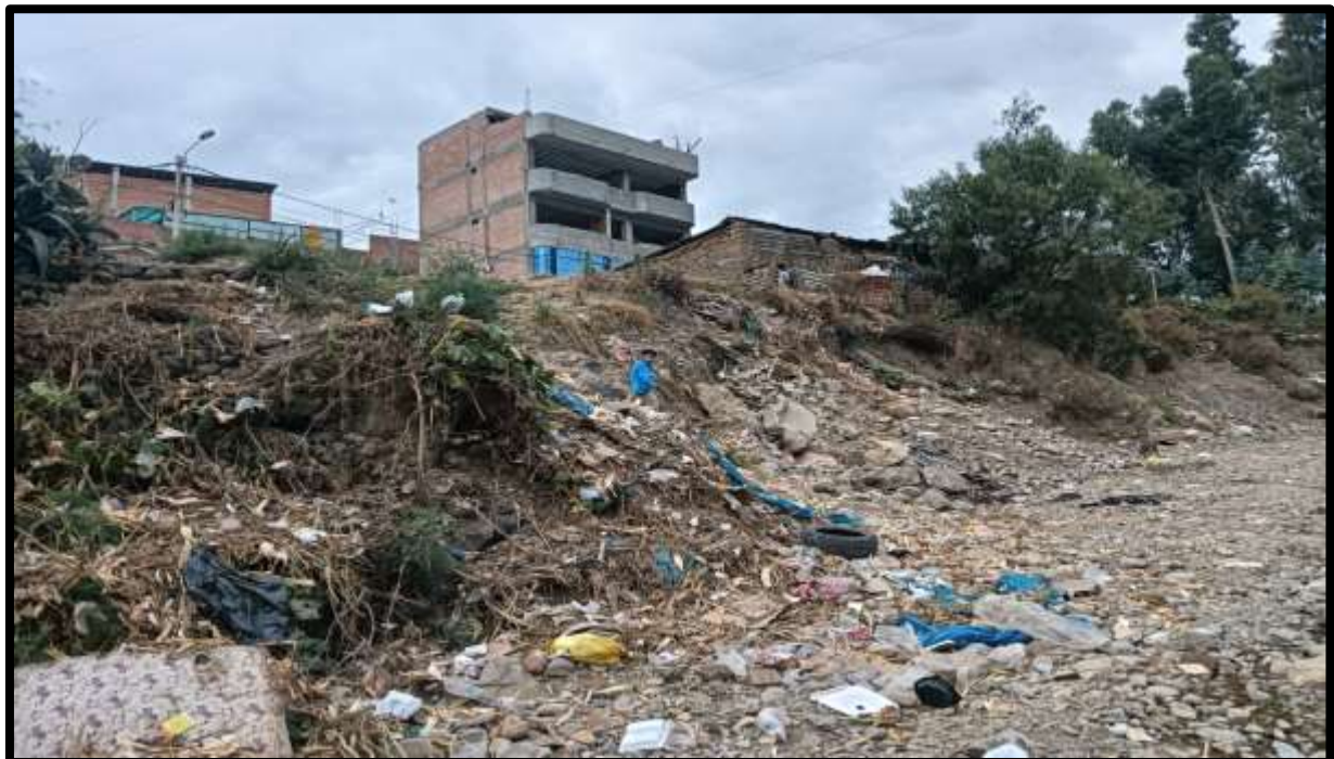
Figura 8: Vista acumulación de basura muro de gaviones del rio seco
