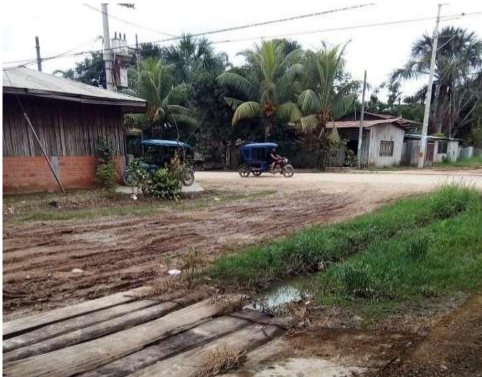
El Asentamiento Humano Nuevo Bolognesi, donde algunas de las calles están deterioradas, dificultando el pase a los transeúntes y movilidades.
