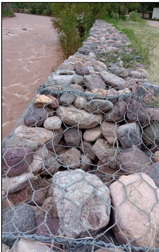
Figura 5: Punto de deficiencia del muro de gaviones. Fuente: Foto obtenida de campo
