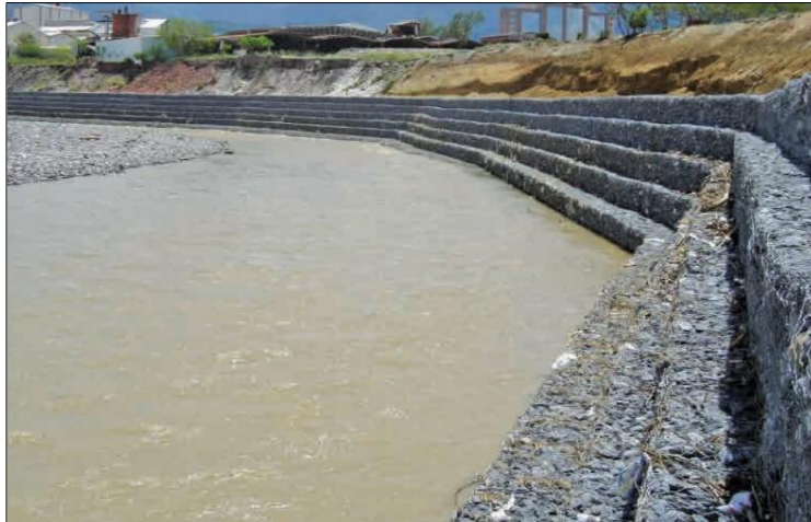
Figura 07: Resistencia de los muros de gaviones.
