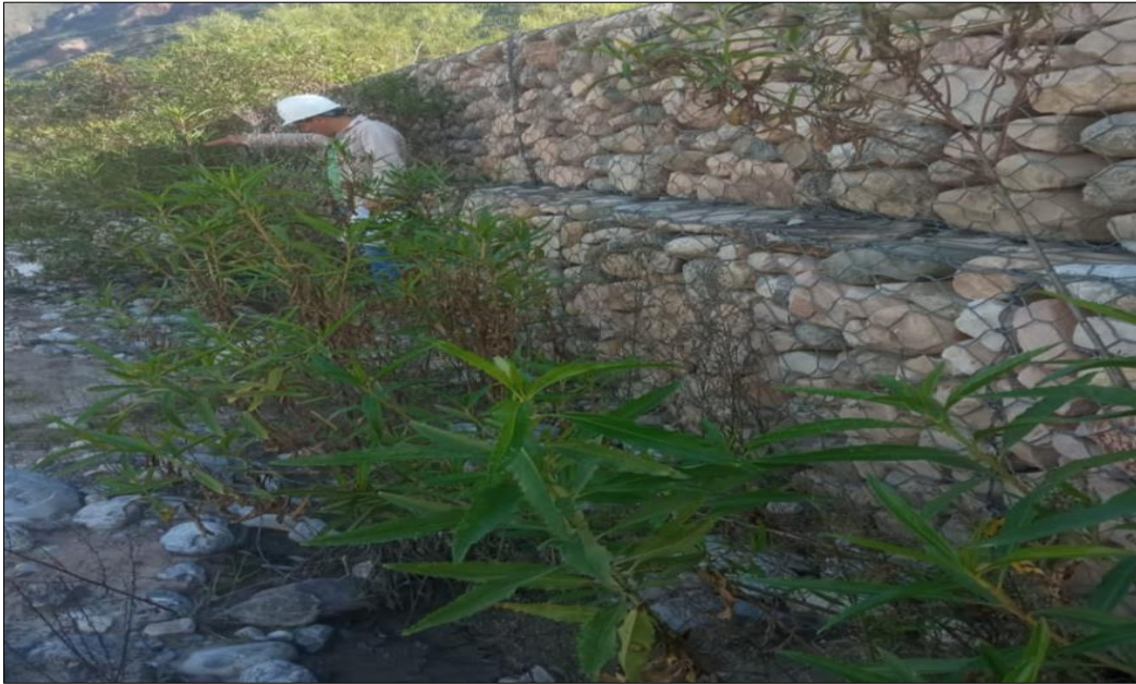
Foto 01: Se observa exceso de vegetación alrededor de la estructura.
