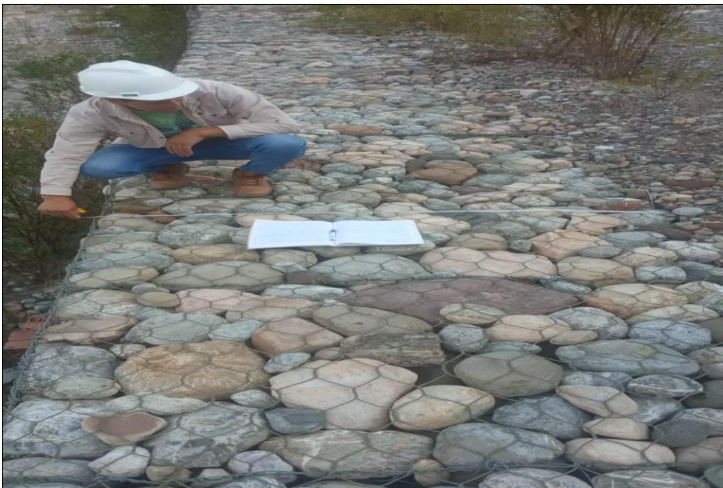
Foto 02: Se observa la medición del muro de gavión de ancho de la estructura existente.
