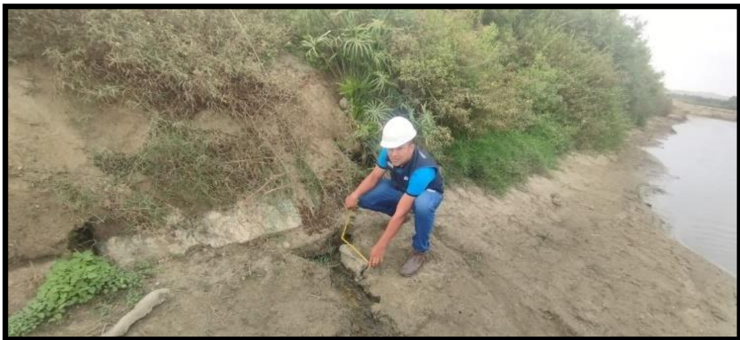
Figura 28: Desprendimientos de rocas
