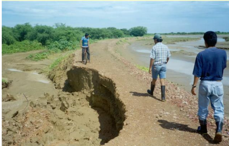
Figura 03: Erosión por ambos taludes en el Río Motupe Viejo
