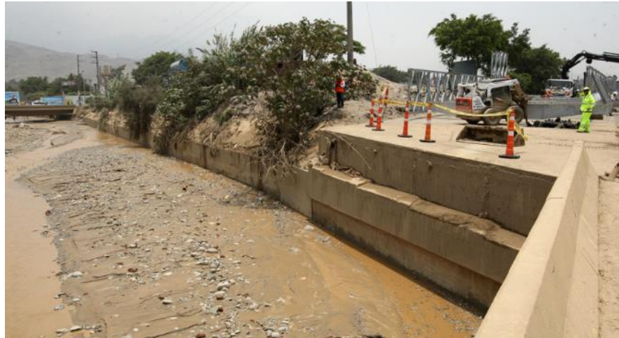
Figura 17: Muro de contención en el Río Huaycoloro.
