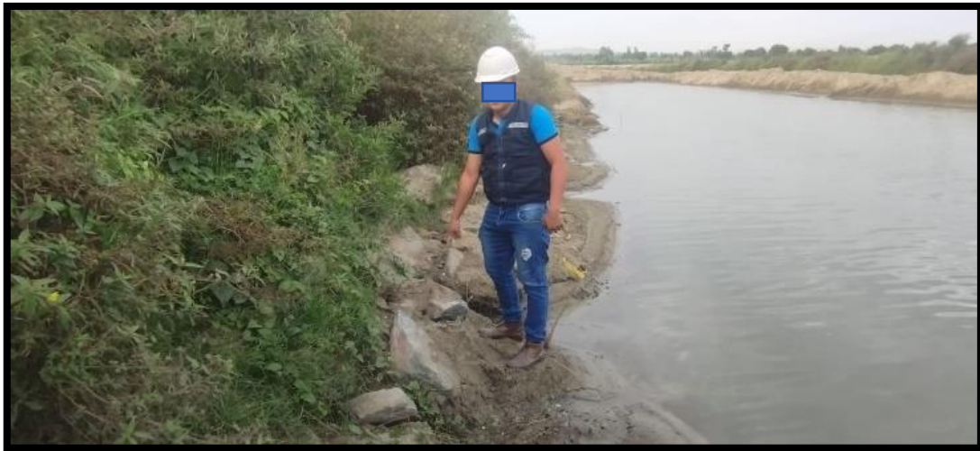
Figura 27: Desprendimientos de rocas
