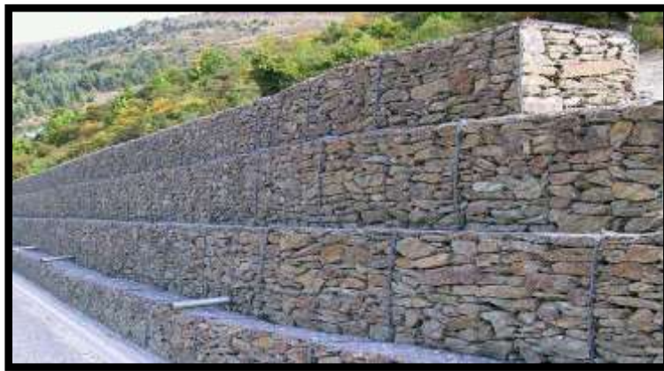
Figura 3. Muro de gaviones.
