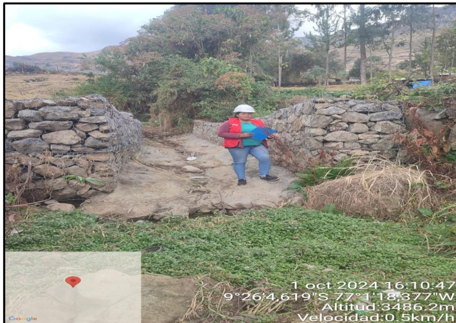
Figura 6: Riesgo por socavación en la progresiva 2+090
