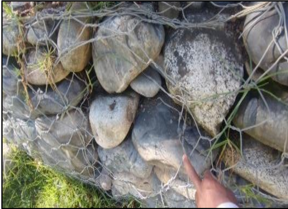
Figura 10: Se observo rotura y deformación en 2+420
