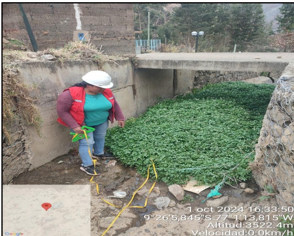
Figura 9: En esta progresiva de 2+380, se ha identificado socavación
