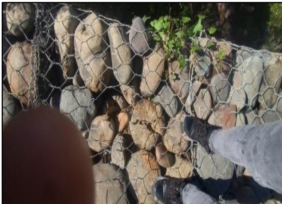
Figura 7: Se visualizo la rotura de malla galvanizada en 2+180
