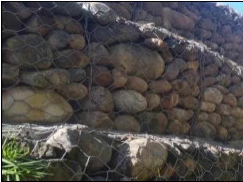
Figura 8: En progresiva 2+250 a 2+280 hay deformaciones de muro.
